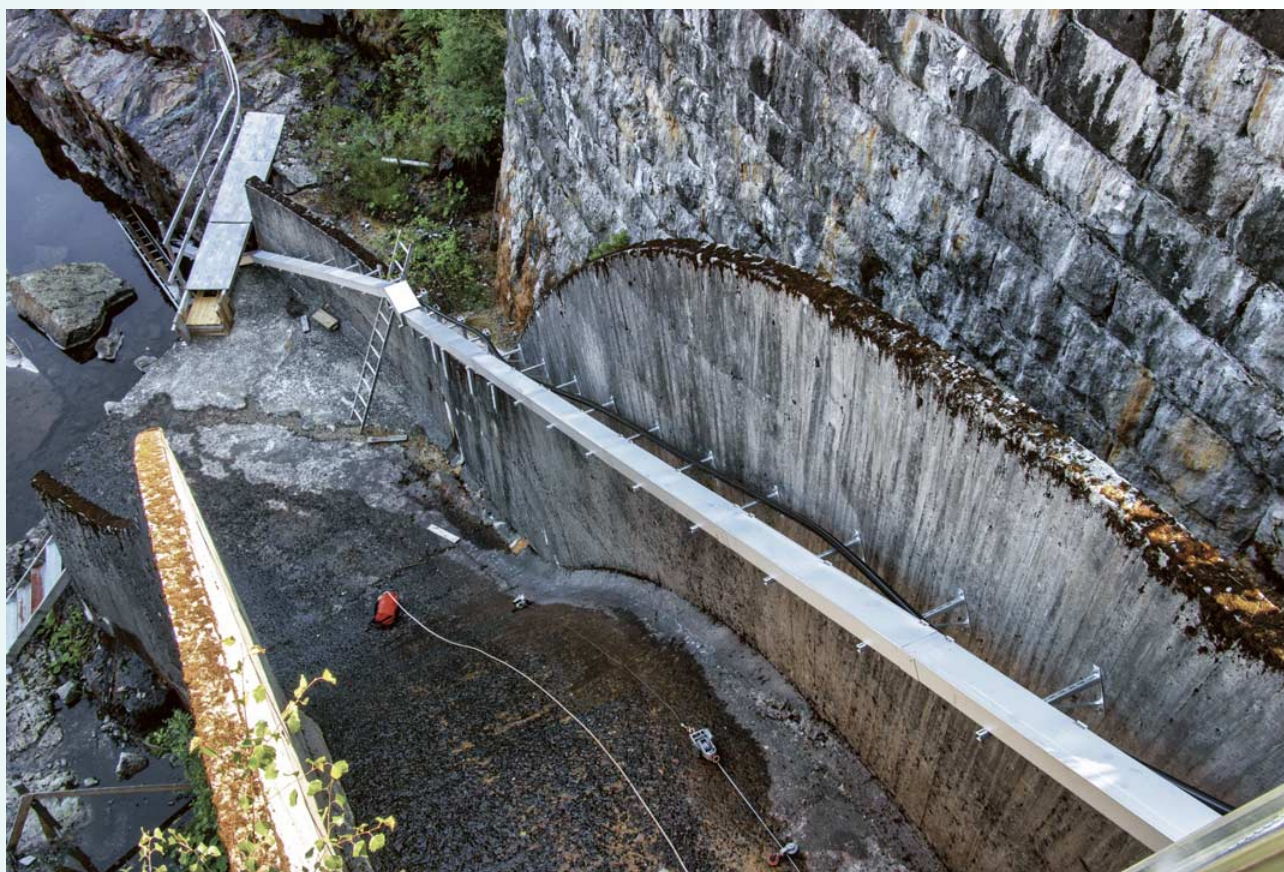
Ålepassasje i Nye Dalsfoss kraftverk
