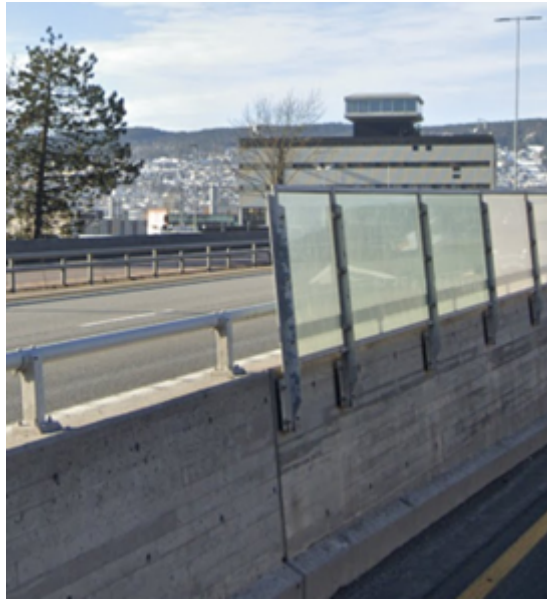
Figur 4.2.3—2 — Eksempel på støyskjerm montert på ikke-ettergivende rekkverk.
