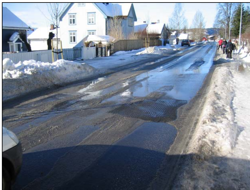
Figur 2.28 Slitasje på fartspute som følge av brøyting
