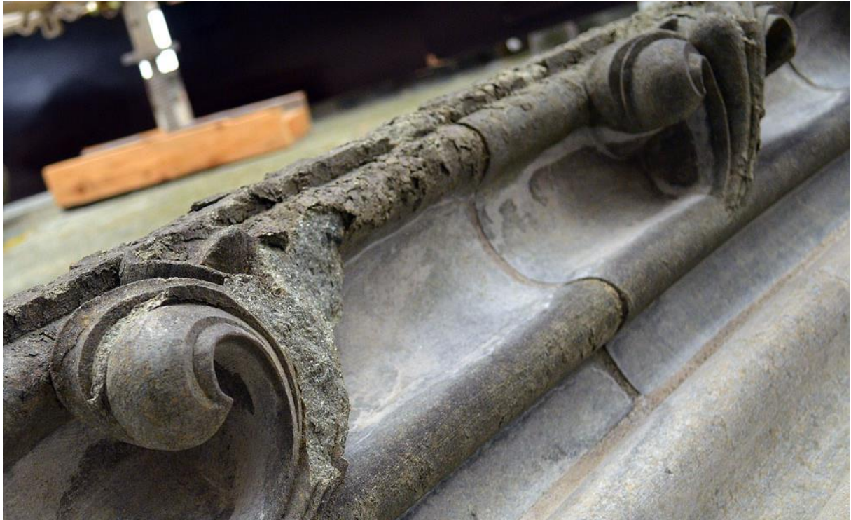
STAVANGER: Forvitret Kviknekleber på Stavanger domkirke i 2016 – etter bare 30 års «tjeneste». Det største problemet er at biter faller ned fra stor høyde. Her må det erstattes. Men med hvilken kleberstein? Foto: Per Storemyr
