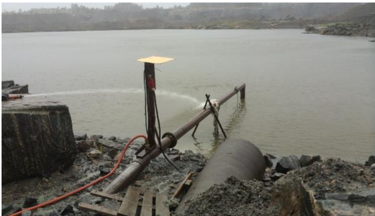
Figur 15 Eksisterende sedimenteringsdam med pumpeanlegg til sjø
