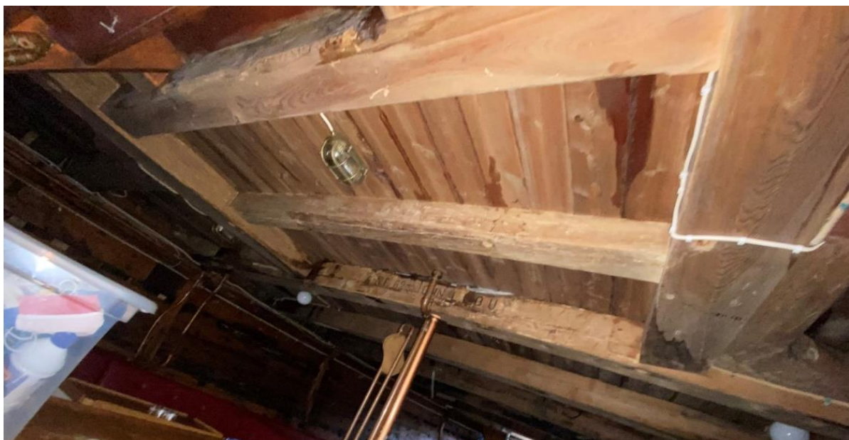
figur 84: Dekksbjelker med to kraveller, mulig spor etter gammel skylight
