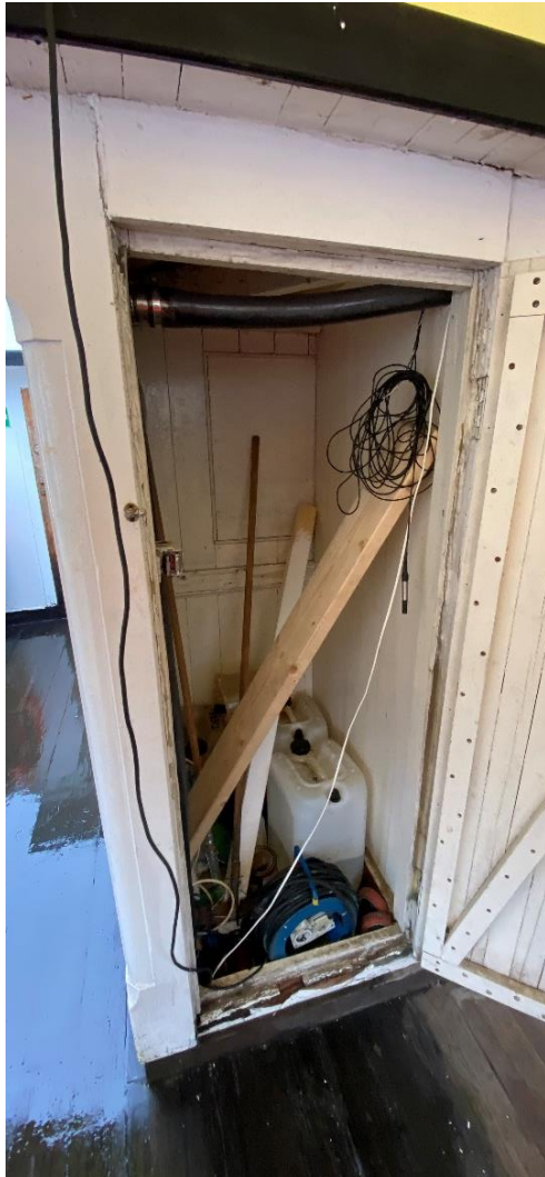
Figur 111: Spor etter gammel åpning i veggen fra bestikk (320?) til skap 323, 2021.
