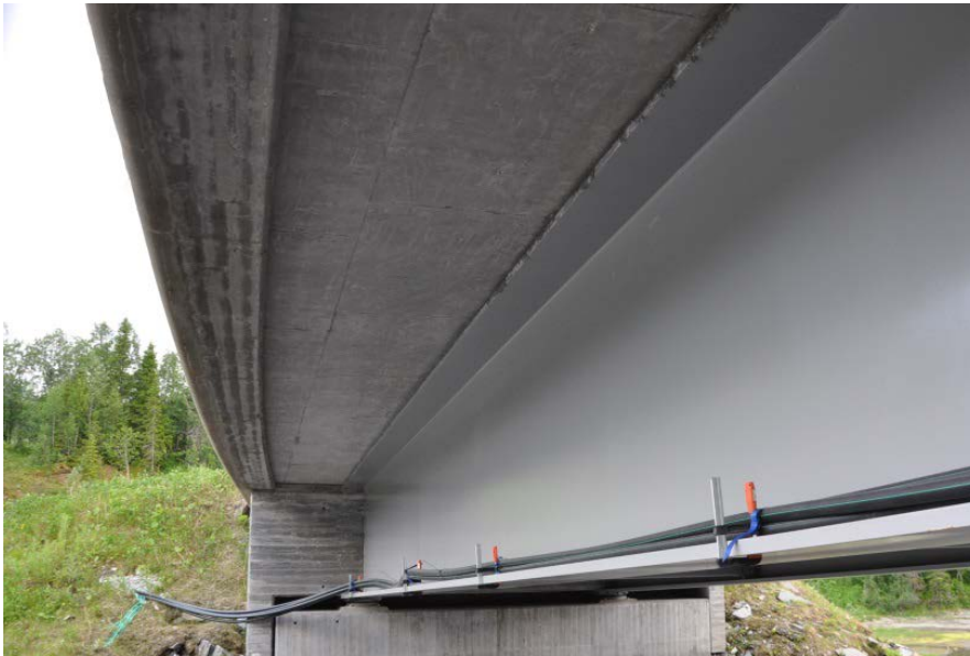
Figur 24 Manglende trekkerør (foto fra Brutus)
