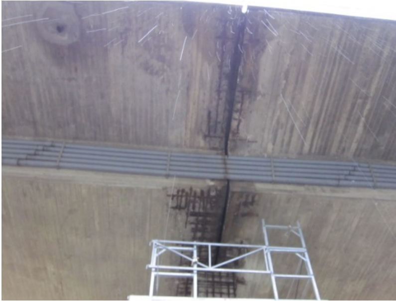
Figur 1 Armeringskorrosjon under fuge som følge av klorider (foto: Gaute Nordbotten)
