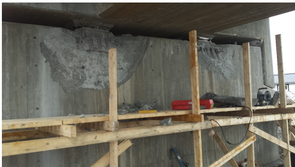
Figur 30 Skade på innfesting av fastlagre (foto: Odd Bjarne Norheim)
