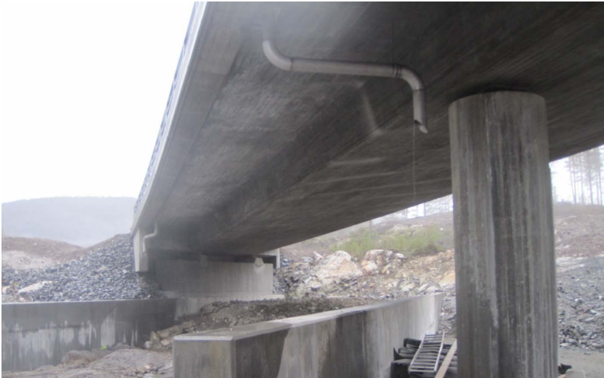
Figur 22 Uheldig utløp fra sluk (foto: Arve Aaby), løsningen er senere bygget om
