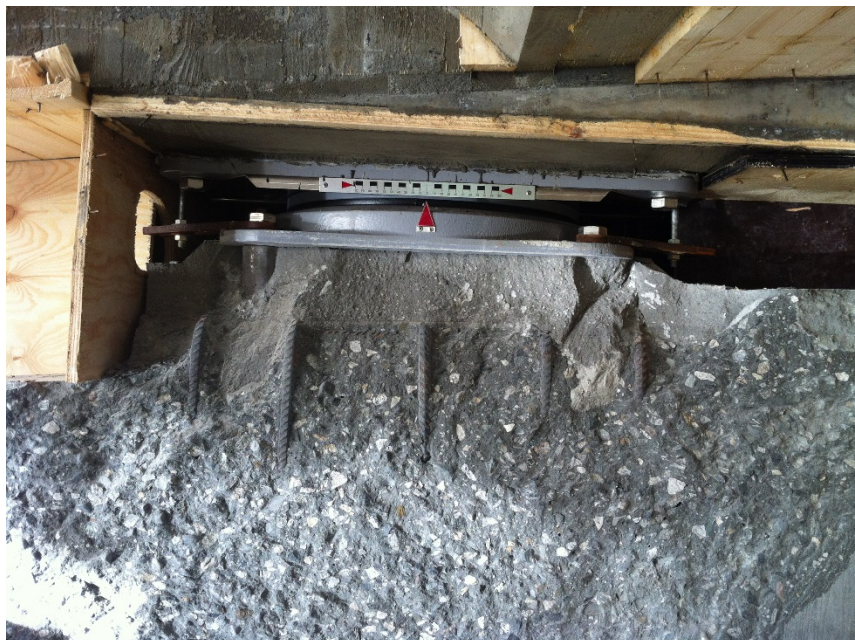
Figur 18 Lager montert med bevegesretning feil veg (foto: ukjent, bru: ukjent)
