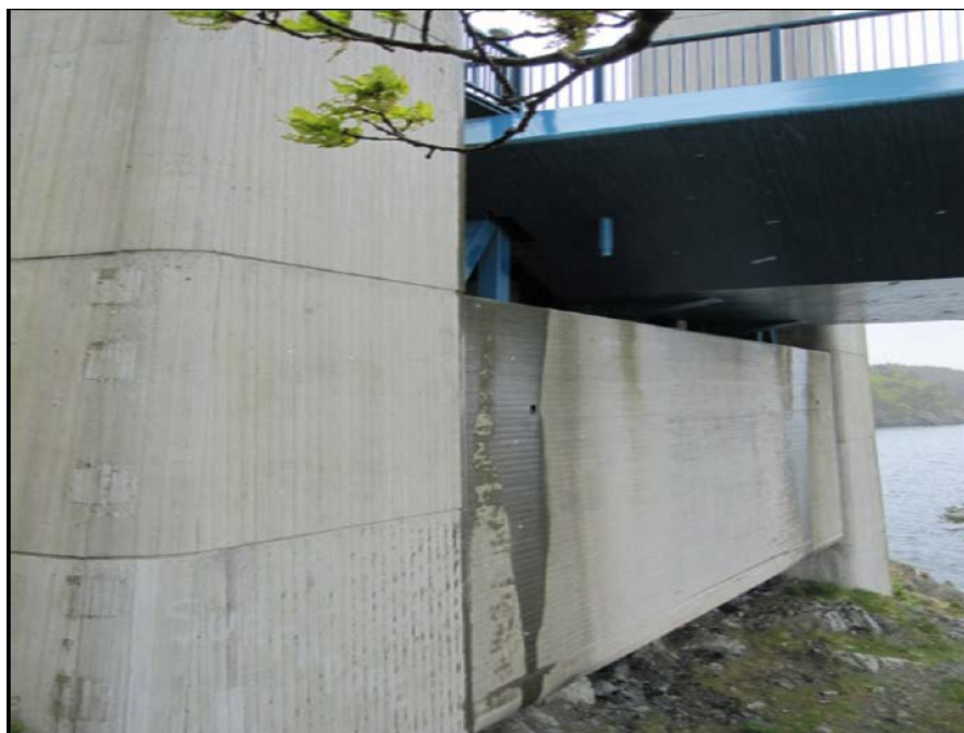
Figur 11 Lekkasje i fuge (foto: Gaute Nordbotten)
