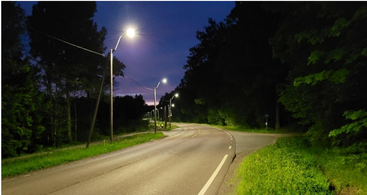
Figur 5: Hortensveien (Fv 325) nord for Tønsberg er godt belyst om natten. Foto: Erling Fjeldaas, Statens vegvesen.
