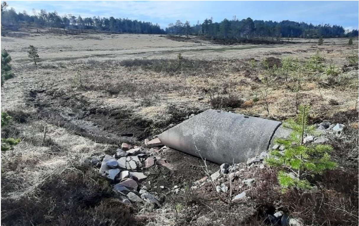
Figur 13. Det anbefales enkle utbedringer nedenfor utløpet fra Kulvert C.
