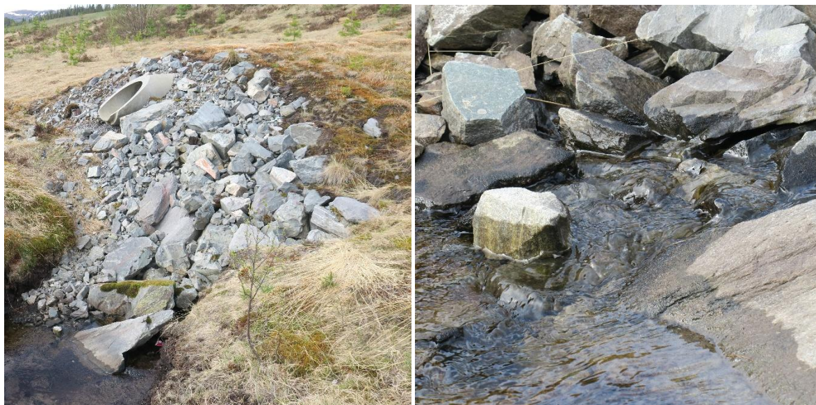
Figur 11. Det rant ikke vann gjennom kulverten under befaringa i mai (t.v.), mens det kom betydelige mengder vann ut fra vegfyllinga (t.h.)
