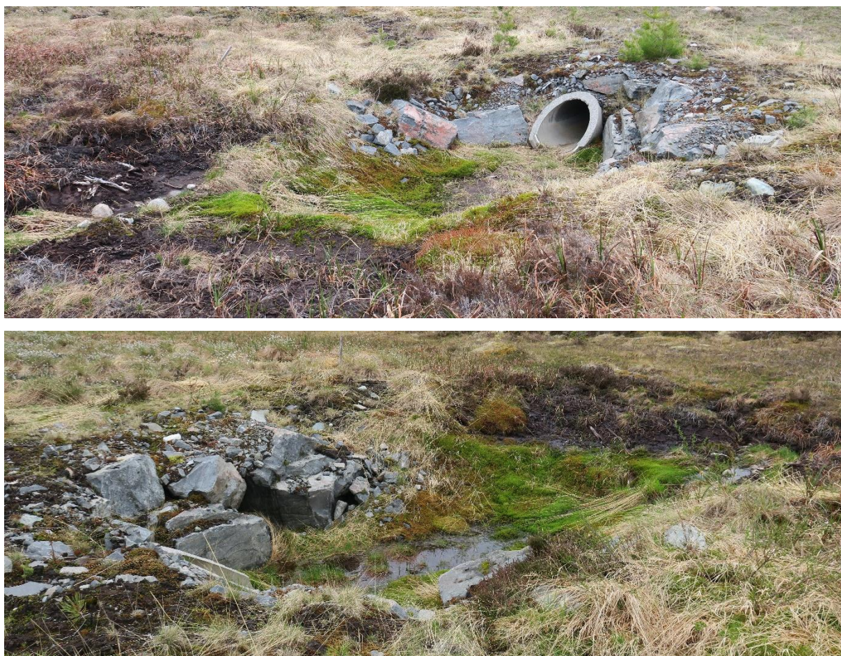
Figur 8. Gropa foran innløpet til kulvert A anbefales redusert.
