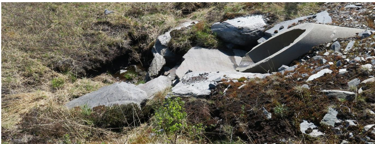
Figur 17. Hullet nedenfor kulvert E anbefales gjenfylt.
