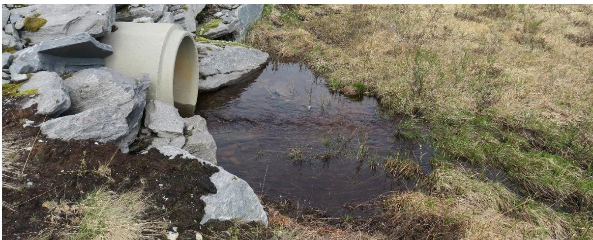
Figur 15. Ved utløpet fra kulvert D anbefales en mindre utbedring for å hindre erosjon.
