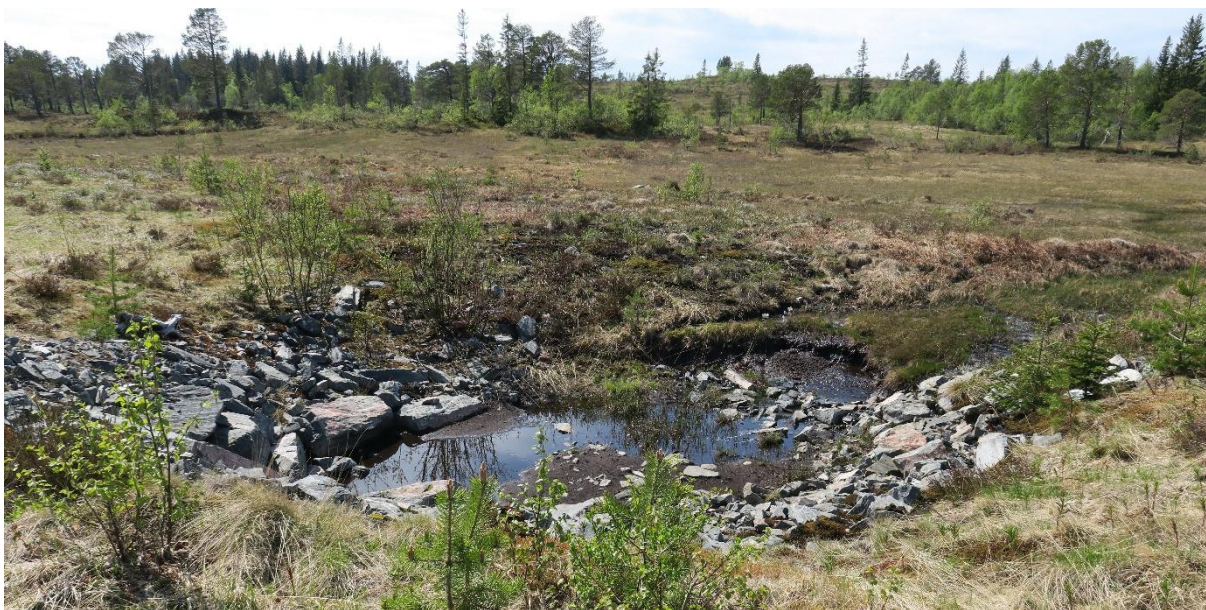
Figur 16. Det anbefales å gjøre gropa foran kulvert E mindre slik at vannstanden i tiliggende deler av myrområdet heves.
