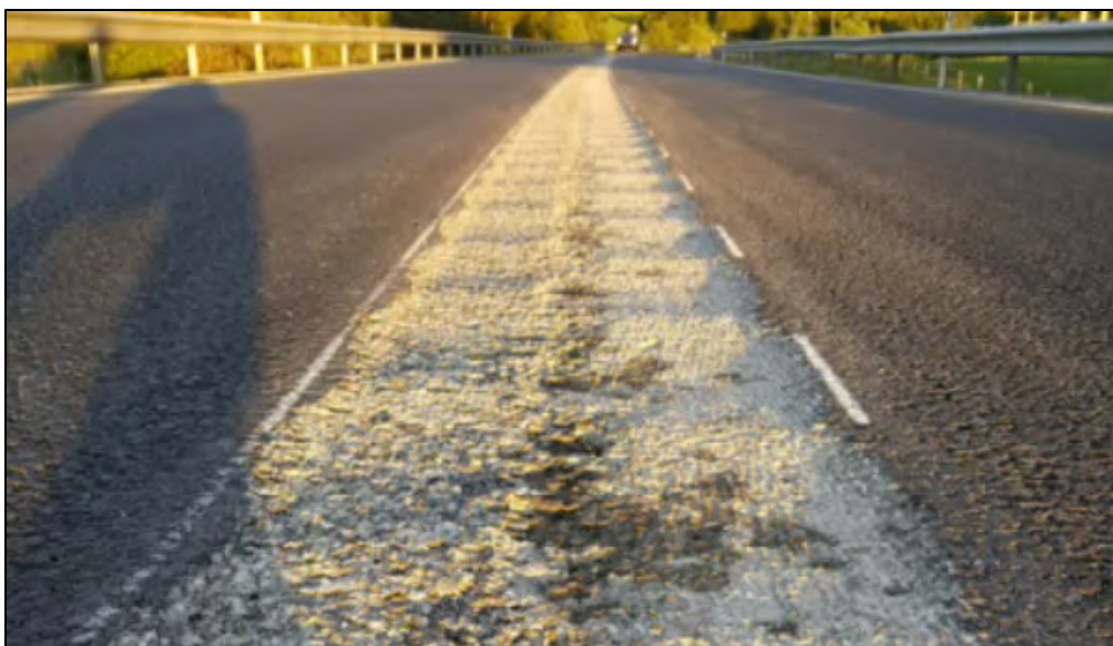
Figur 9-6: FMO med sporbredde 55 centimeter på Europaveg 6 i Innlandet fylke. Asfaltskader i midtskjøt grunnet dårlig komprimering av asfalt under overlappen (hulrom. (Richard Skjæret, ukjent dato).
