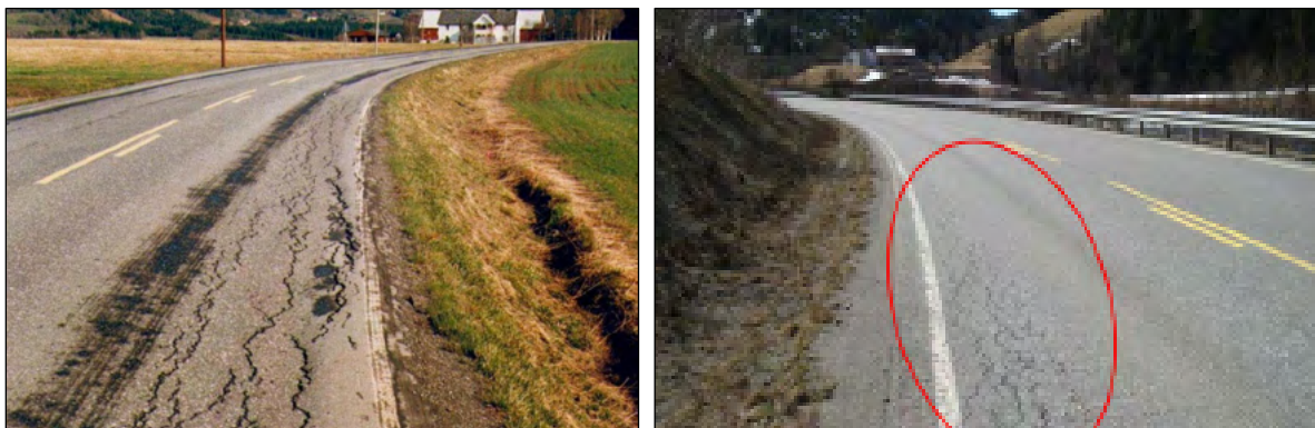
Figur 10-3: Kantsprekker (venstre) og krakelering i ytre spor (høyre) (Weydahl, 2011, ss. 10-11).
