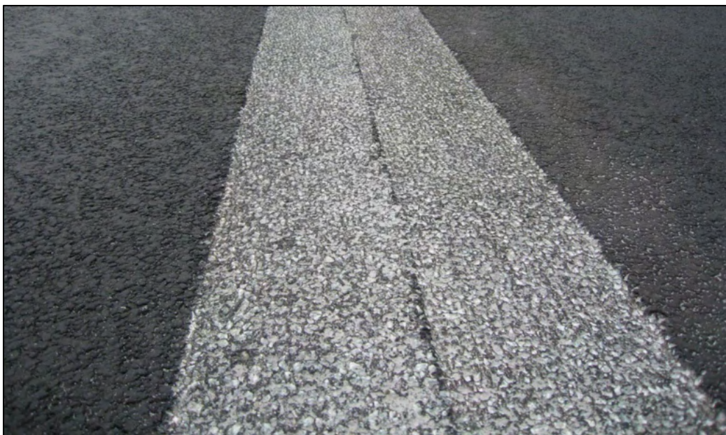
Figur 9-7: FMO i 55 centimeter bredde med utilstrekkelig overlapp mellom kuttene (Richard Skjæret, ukjent dato).
