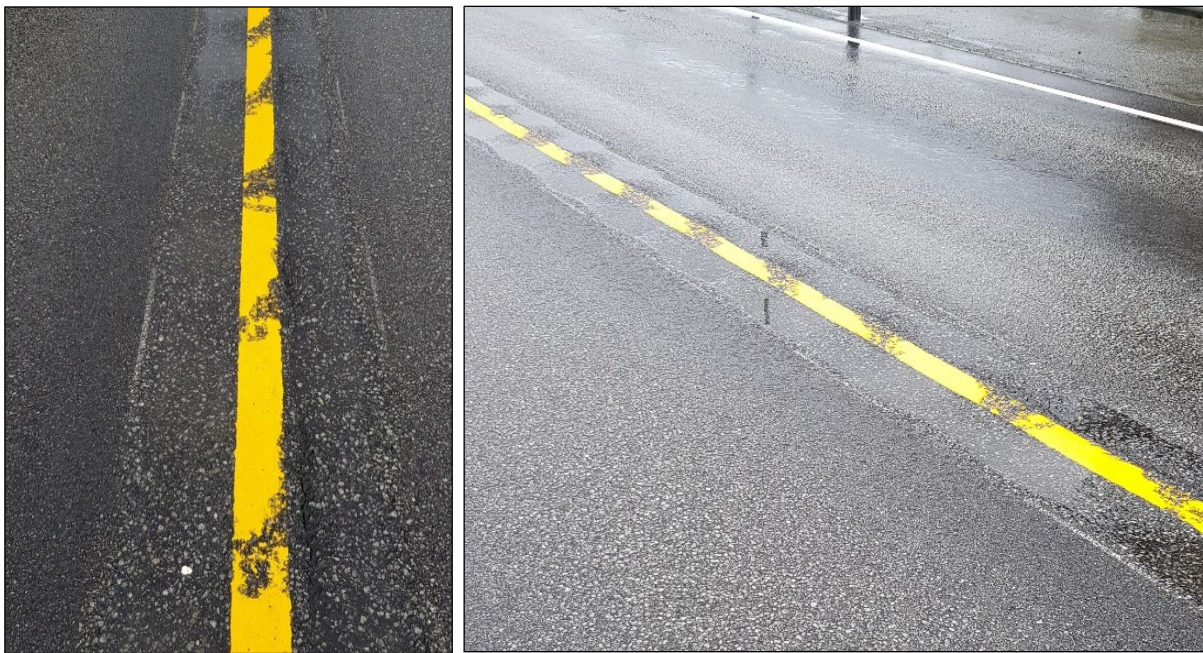
Figur 15-2: Brøyteskader ved bølgetopp på FMO på E39 på Stord (Lars Nybø, 2023).
