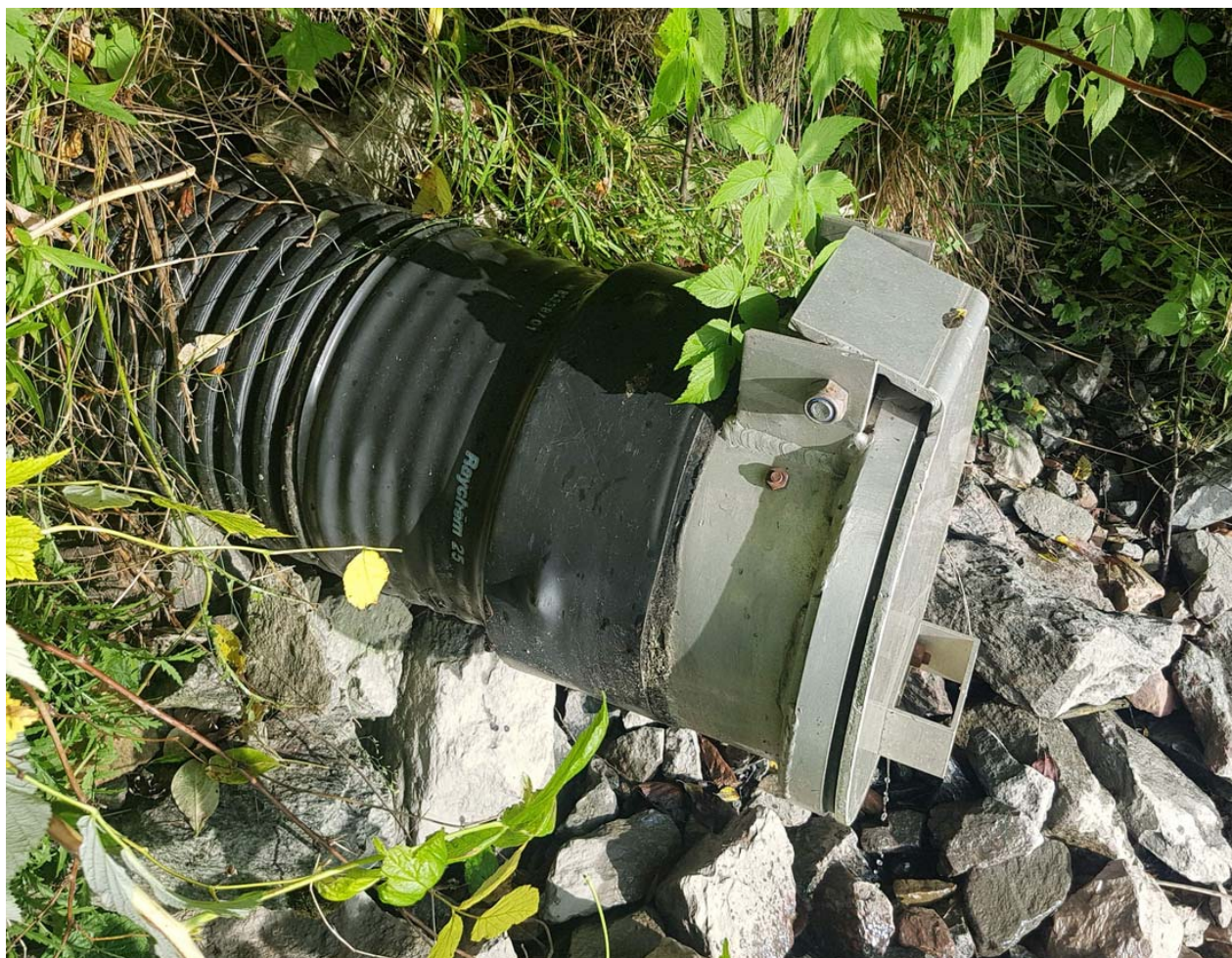
Figur 7 – Lavvannrør med tilbakeslagsventil gjennom flomverk (Bilde: Multiconsult)
