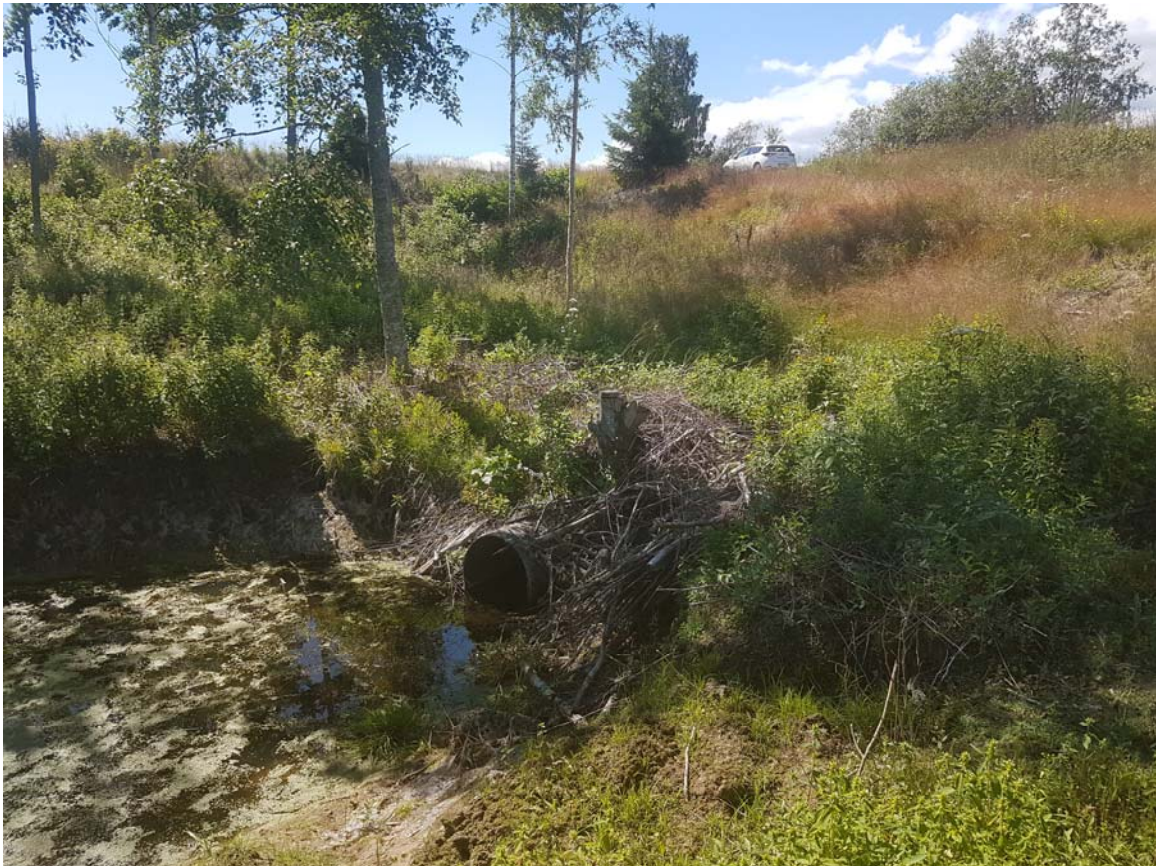
Figur 12- Lavvannrør uten tilbakeslagsventil gjennom flomverket (Bilde: Multiconsult)
