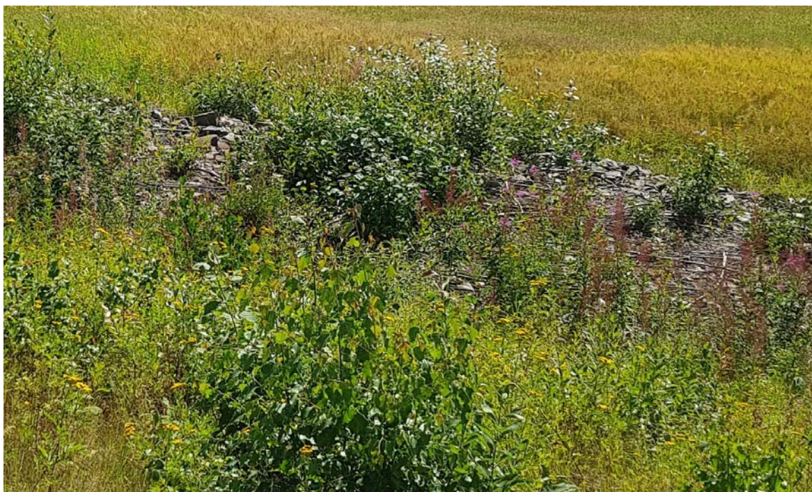
Figur 18 – Indre erosjon (sandkoking) reparert i søndre flomverk (Bilde: Multiconsult)
