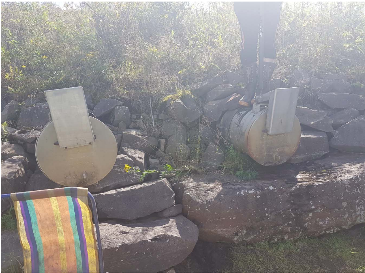
Figur 15 – Ø450 pumperør gjennom flomverk ved Nesevja pumpestasjon (Bilde: Multiconsult)
