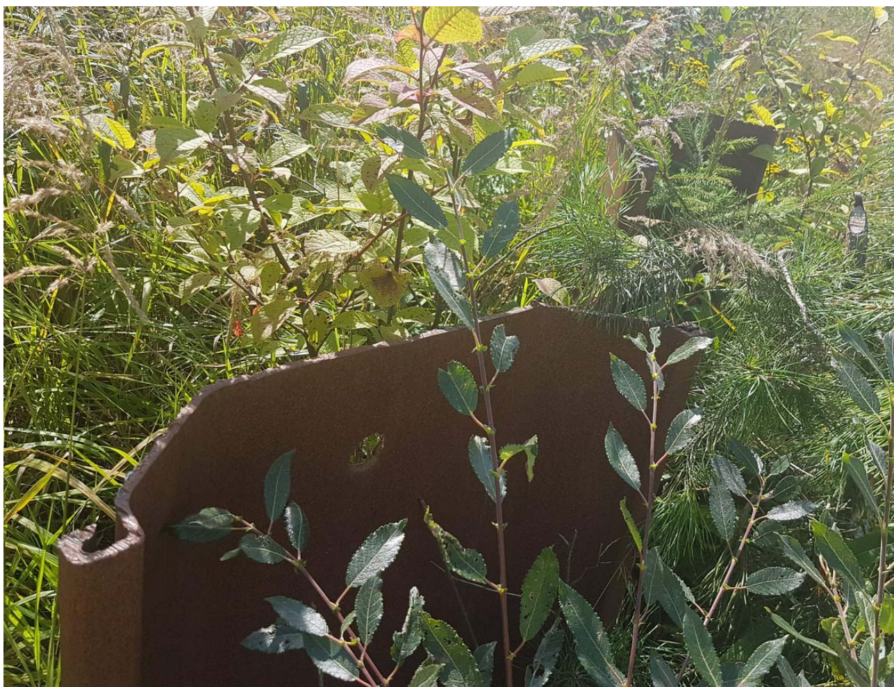
Figur 12 –Spunt som stikker ut av flomverket ved Nesevja pumpestasjonen (bilde: Multiconsult)
