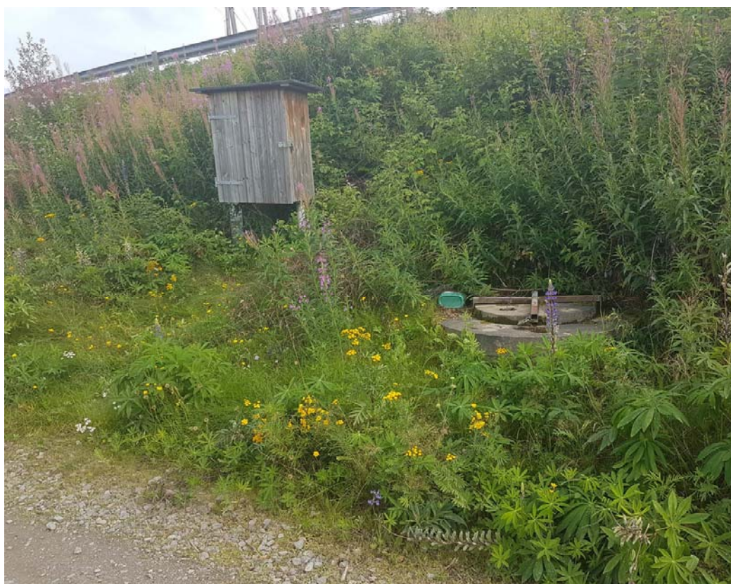
Figur 17 –Den sørlige pumpestasjon – VV 8545 Arneberg (Bilde: Multiconsult)
