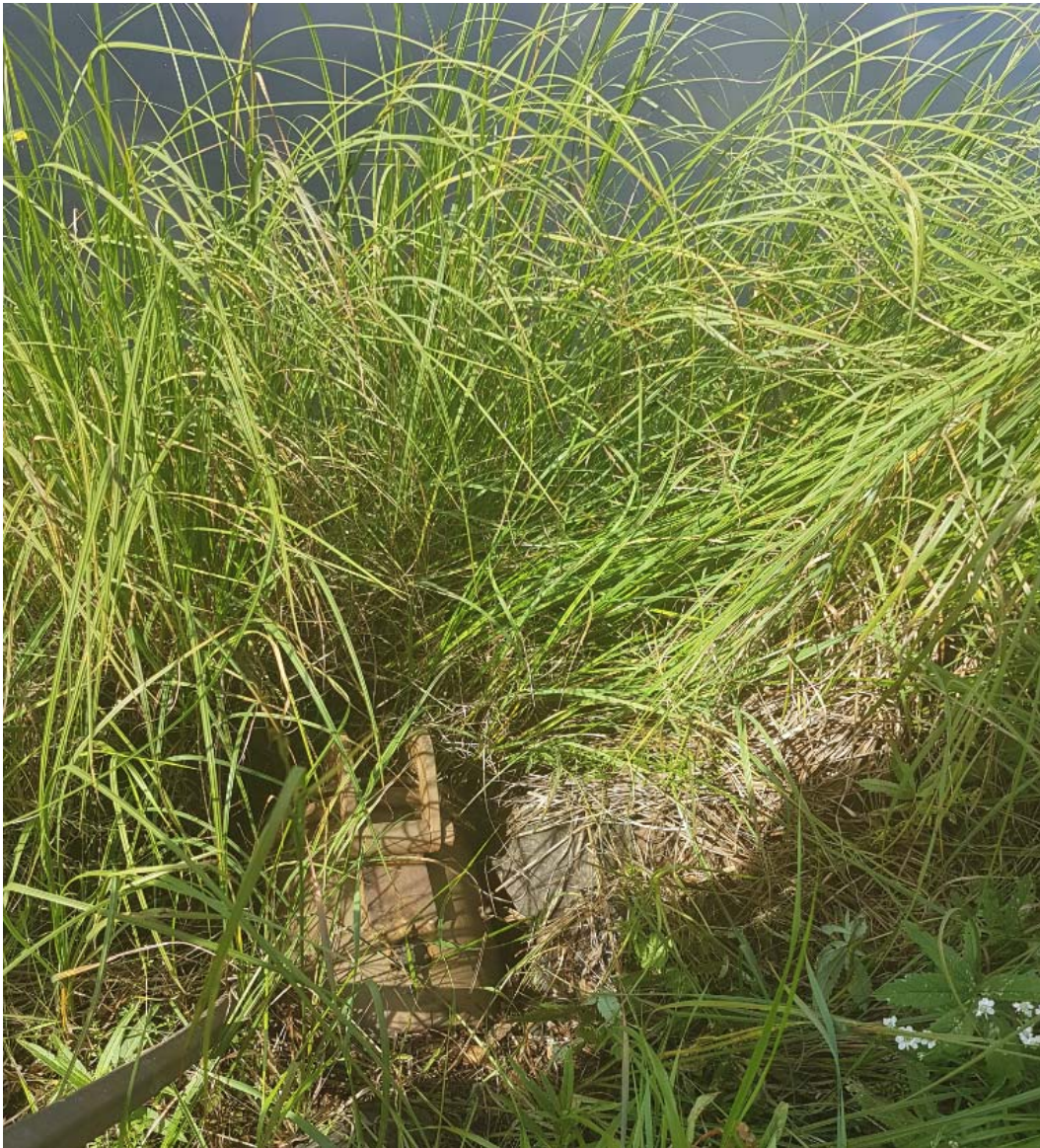
Figur 13 – Ø250 rør med ventil gjennom flomverk i oppstrøms ende. Ventilen har begrenset funksjon pga. jord og gress (Bilde: Multiconsult)
