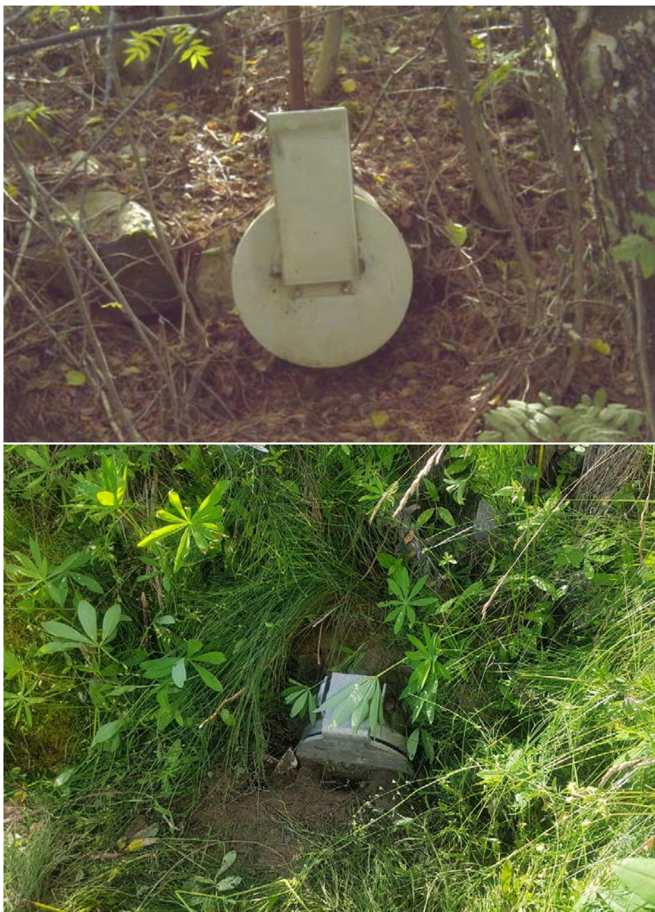
Figur 11 – Lavvannsrør med tilbakeslagsventil gjennom flomverk (Bilder: Multiconsult)
