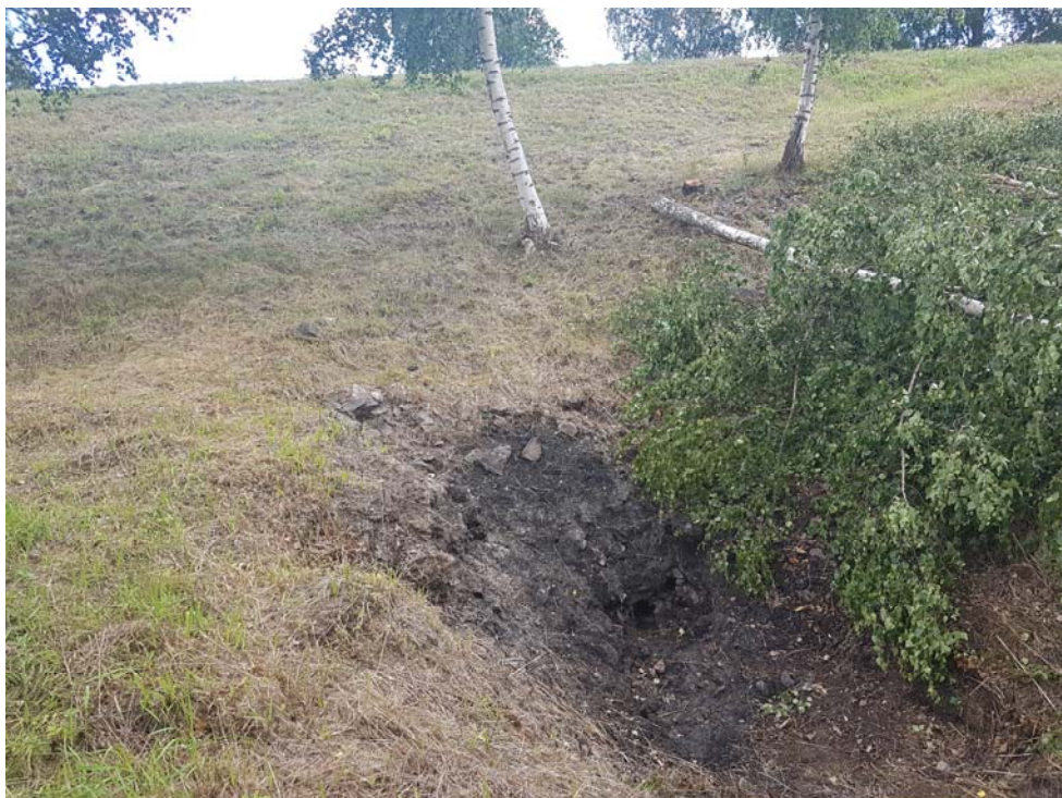
Figur 12 – Åpning gjennom flomverk med et lavvannsrør i dårlig forfatning i nedstrøms ende av flomverket (bilde fra luftside) (Bilde: Multiconsult).
