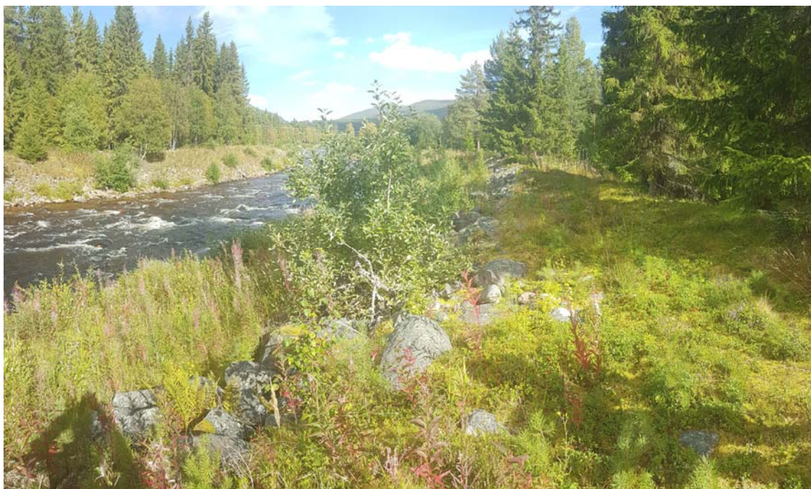
Figur 8- Isgangverket mot Mistra. Skader på erosjonssikringen er ikke synlig på grunn av buskene (Bilde: Multiconsult)
