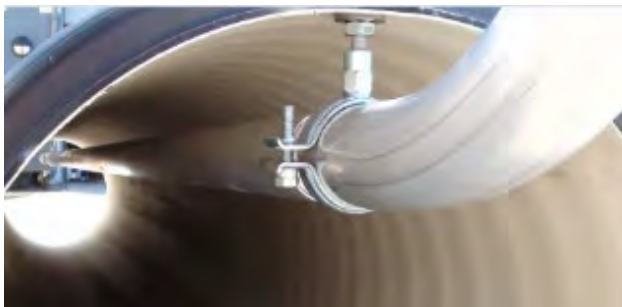
Figur 9-17 HeatWork. Tinerør montert inni stikkrenne (Foto: HeatWork)
