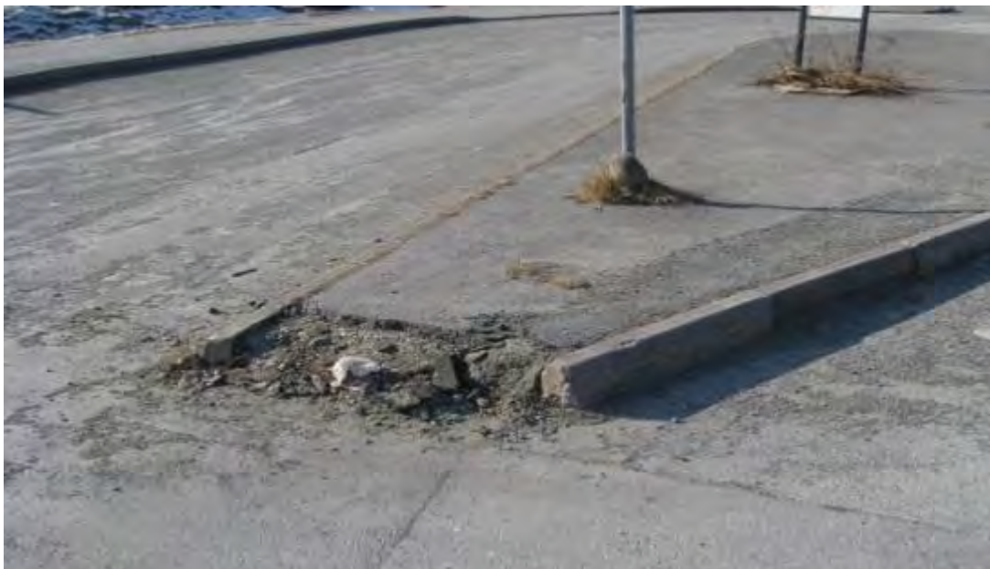
Figur 9-39 Skade på trafikkøyr og kantstein fra brøyting (Foto: Statens vegvesen)
