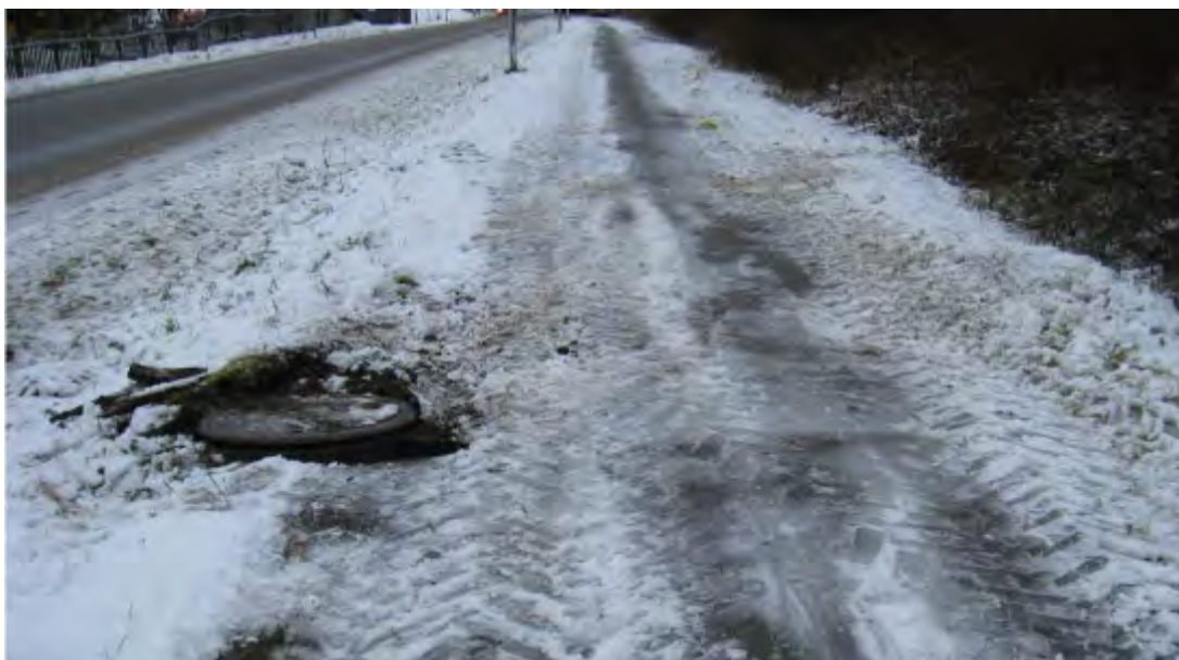
Figur 9-40 Skade på kum/ sluk (Foto: Statens vegvesen)
