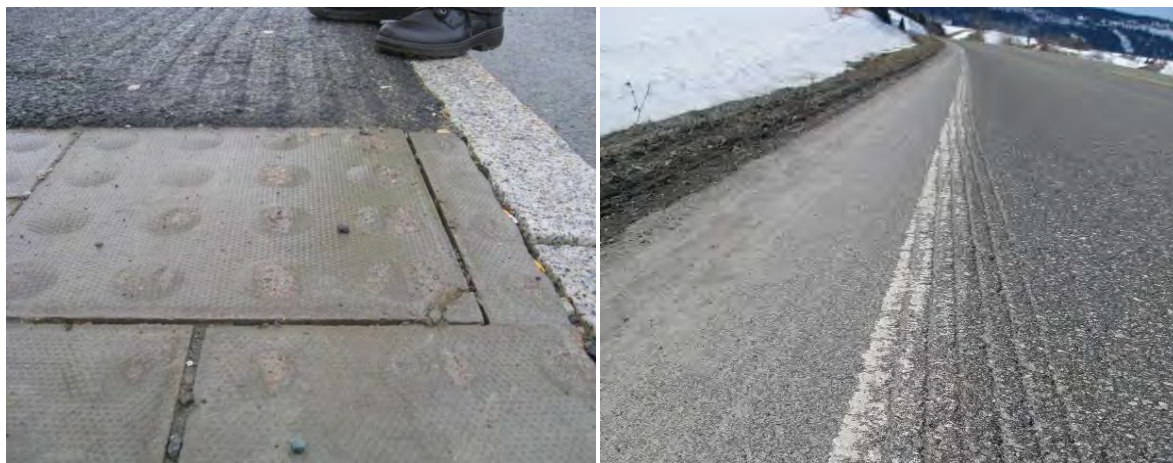
Figur 1-3 Skader fra veghøvel på taktile heller og asfaltdekke. (Foto: Øystein Larsen, Statens vegvesen)
