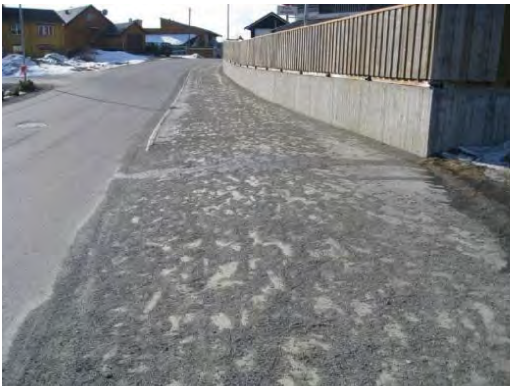
Figur 7-20 Her ligger det igjen strøsand fra hele vinteren (Foto: Statens vegvesen)
