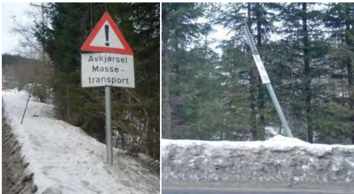
Figur 9-36 Skade på skilt (Foto: Statens vegvesen)
