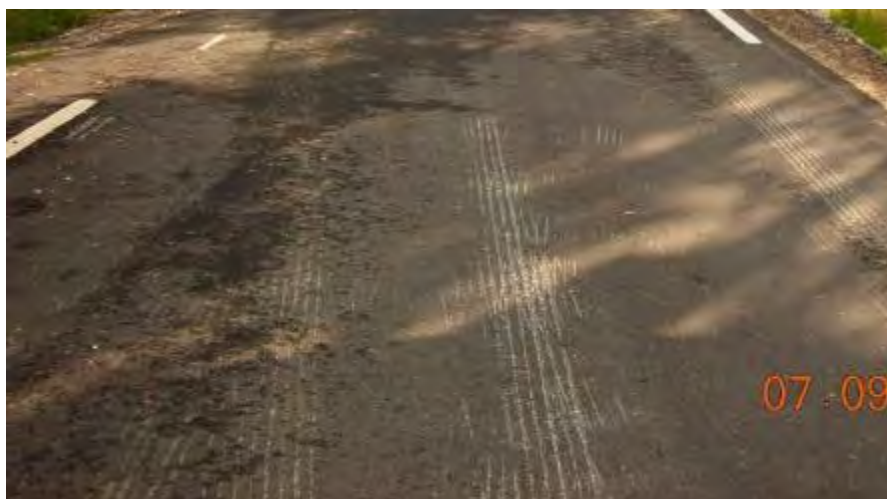
Figur 4-44 Skader på fast dekke (Foto: Statens vegvesen)
