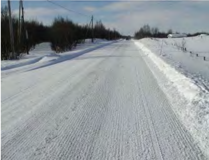
Figur 4-72 Snø- og isdekke etter høvling. Merk manglende utkast av ranke. Dette må gjøres for å hindre nedkjøring og dermed etablering av iskant på skulder. I tillegg bidrar manglende utkast til smalere veg
