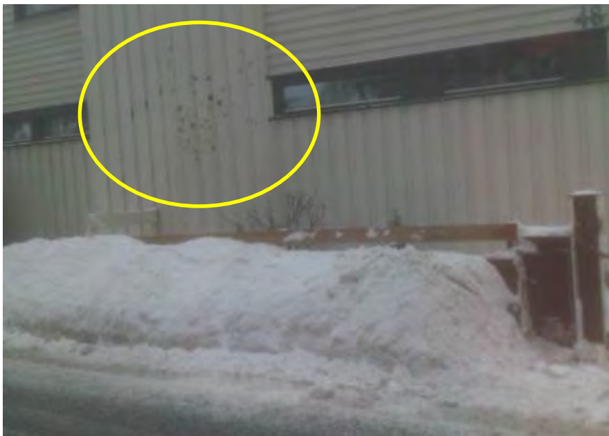
Figur 4-82 Uønsket sprut fra brøyting på fasade (Foto: NVE)
