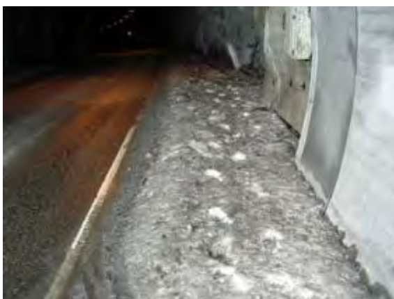
Figur 2-15 Snø på sideareal i tunnelens innkjøringssone (Foto: Toralf Johansen)
