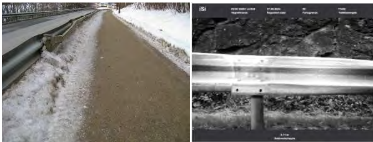
Figur 9-38 Skade på rekkverk fra brøyting (Foto: Statens vegvesen og bilde fra fotoinspeksjon)
