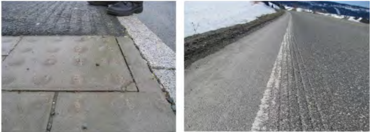
Figur 9-41 Skade på taktile heller og vegmerking (Foto: Statens vegvesen)
