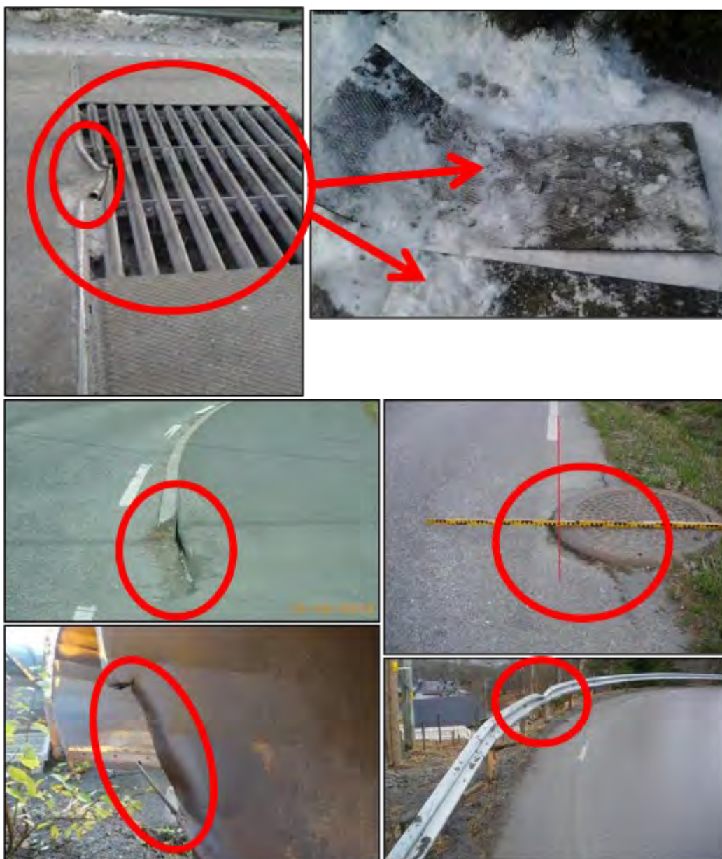
Figur 2-18 Øverst: Hekting/ skade på ferist fra brøyting/ høvling (venstre) og løsrevet dekkplater til ferist (høyre). Midten: Skade på kantstein fra brøyting (venstre) og oppstikkende kum, fare for hekting av plog/ skjær (høyre). Nederst: Skade på plog etter påkjørsel (venstre) og skadet rekkverk (høyre) (Foto: Tom Roar Sveen og Statens vegvesen)
