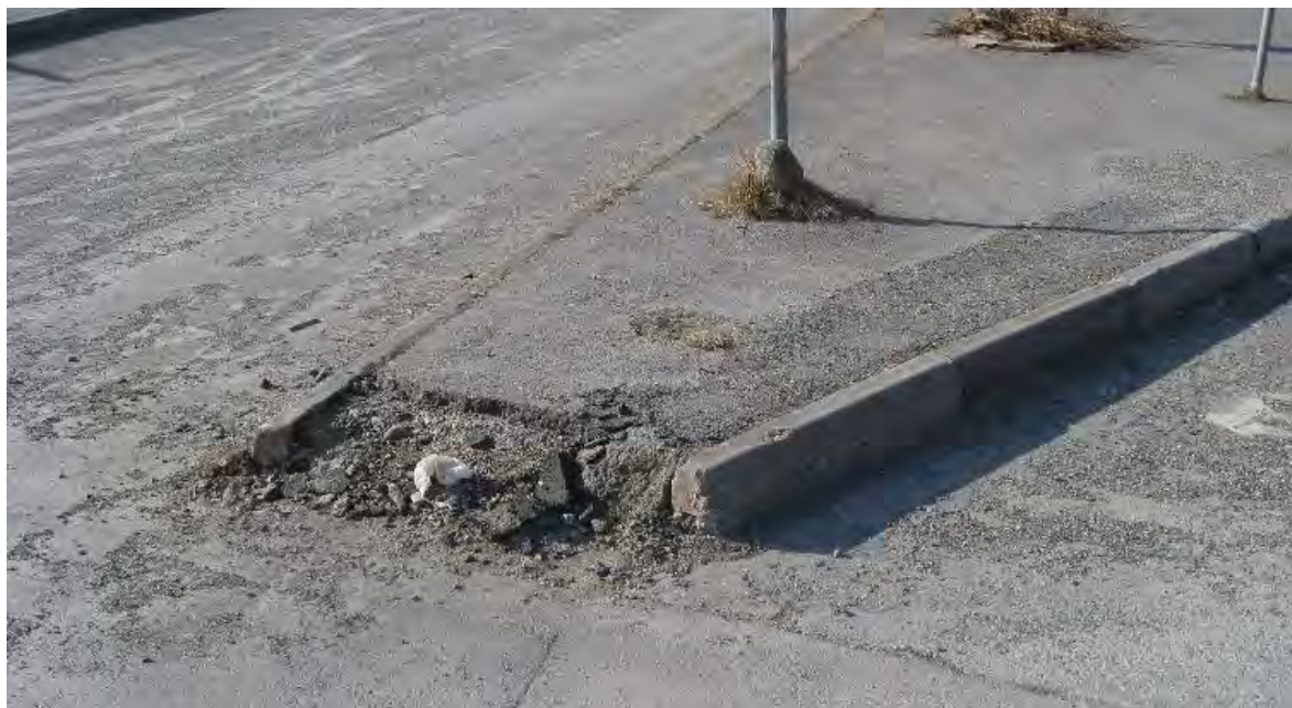
Figur 1-4 Trafikkøyer er utsatt for skader fra brøyteutstyr. (Foto: Øystein Larsen, Statens vegvesen)
