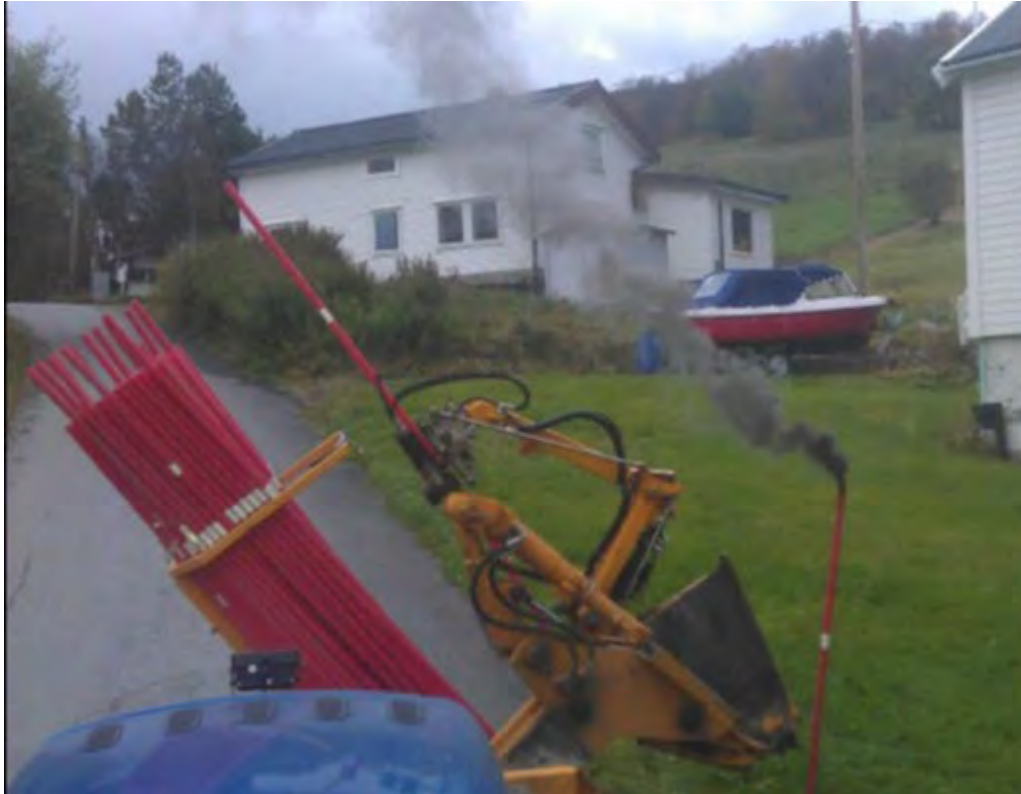
Figur 9-7 Stikksetter treffer høyspentkabel (Foto: Harstad Kommune)
