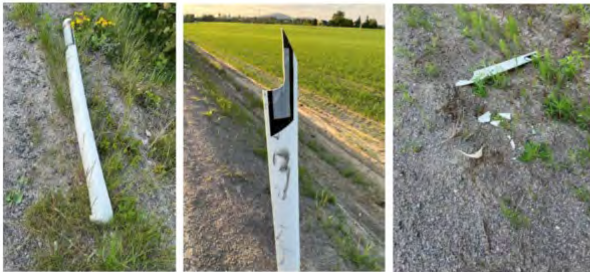
Figur 9-37 Skader på kantstolper (Foto: Ivar Opås)
