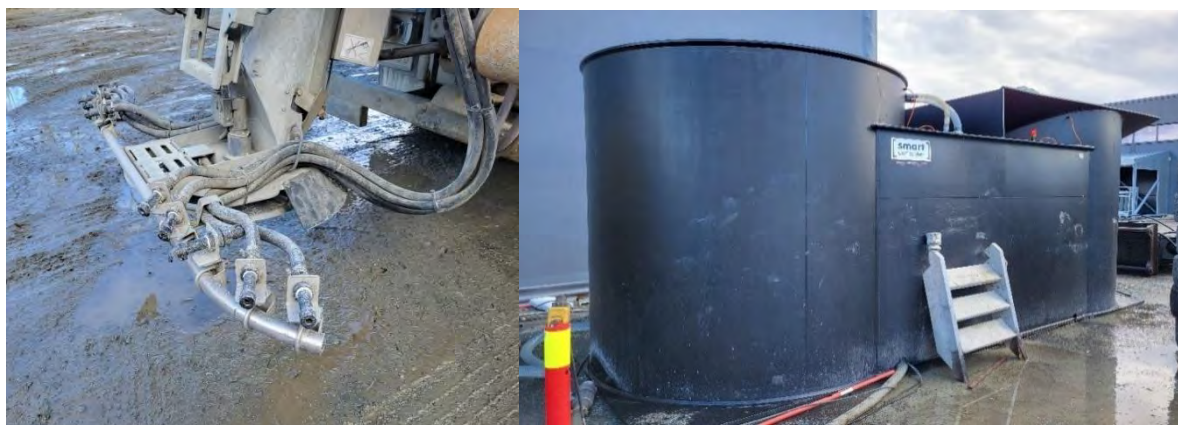
Figur 8-9 Saltdyser til venstre, og blandingsanlegg til høyre (Foto: Statens vegvesen)
