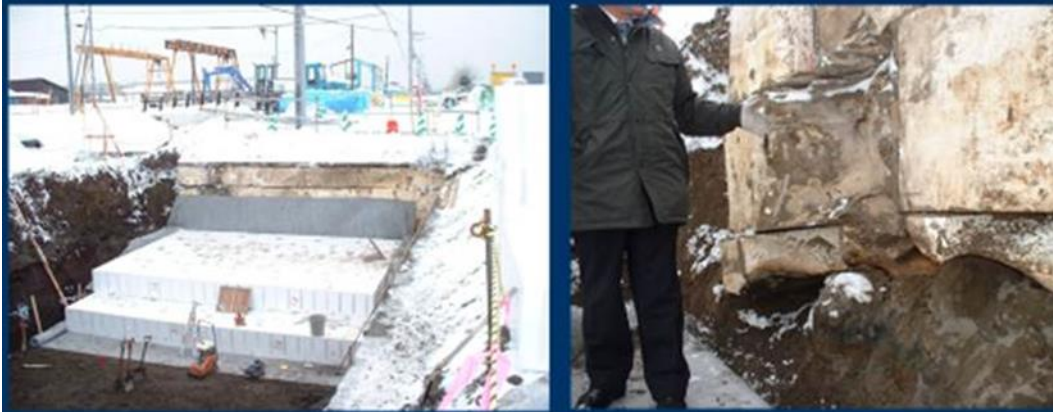
Figur 12. Skade fra bensinlekkasje i Japan. Foto: EDO
