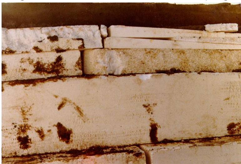
Figur 7. Tvilsom kvalitet av EPS fylling. Foto R. Aabøe Statens vegvesen
