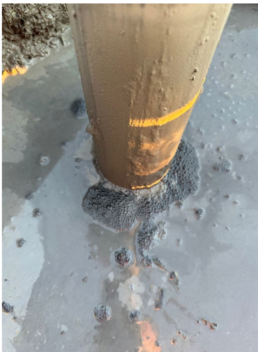
Figur 30 Bilde av mørtelblanding som kom opp da forsøket ble avsluttet. De sorte boblene er det man ofte ser når silika reagerer med superplastiserende tilsetningsstoffer, et tydelig tegn på at hullet var fylt igjen. Foto: Heidi Kjennbakken
