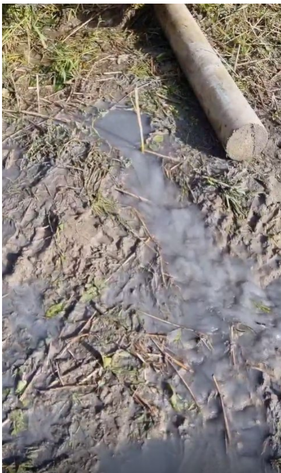
Figur 7 Bilde av lekkasjen etter at det er forsøkt tettet med bentonittstaver, foto tatt den 3.10.2024 (Foto: Bjørn Wold)
