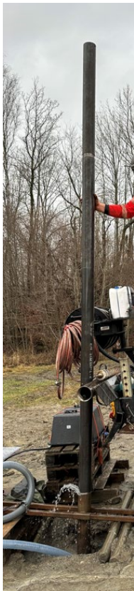
Figur 18 Bilde av 4 m foringsrør (4,3 m over terreng) som viser at det sluttet å renne fra toppen, men det rant ut gjennom nederste gjengekobling. Foto: Heidi Kjennbakken
