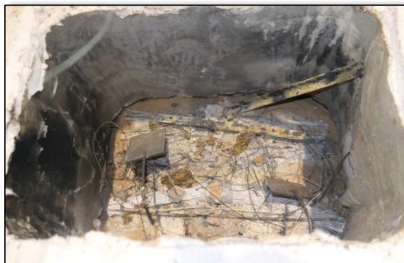
Figur 19 Bildet viser trekummen etter test. Kummen er fullstendig nedsmeltet. Foto: RISE Fire Research.
