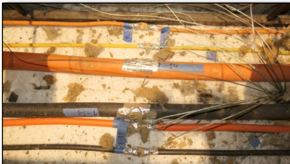
Figur 38 Illustrasjonene viser trekkekum 4a etter gjennomført test. Foto: RISE Fire Research.
