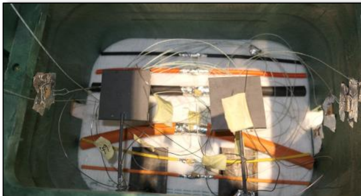
Figur 17 Bildet viser hvordan kablene er plassert i HDPE-kummen. Foto: RISE Fire Research.
