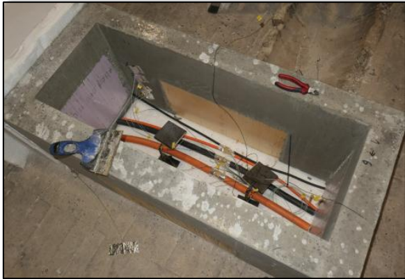
Figur 22 Bildet viser kablene plassert i trekkekum TK2 Tunnel. Foto: RISE Fire Research.
