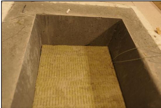
Figur 35 Bildet viser hvordan isolasjonen ligger tett inntil innerveggen på trekkekummen. Foto: RISE Fire Research
