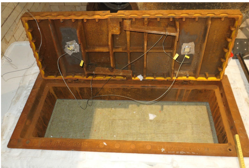
Figur 4.12 Trekkekum 2b etter isolasjonsplate er lagt ned i trekkekummen.
