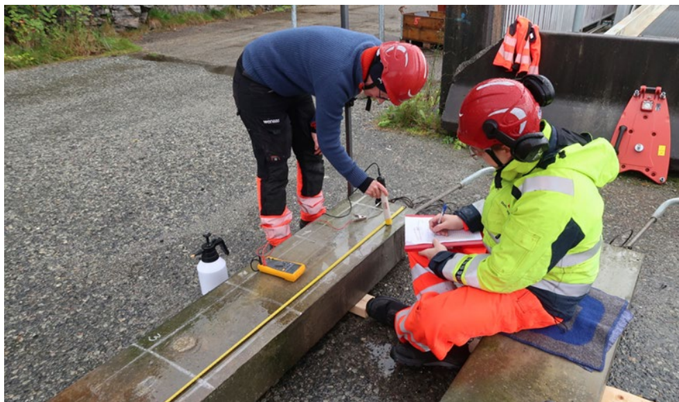
FIGUR 6 MÅLING AV OVERFLATEPOTENSIALER PÅ ELEMENT H1. FOTO: EVA RODUM, STATENS VEGVESEN
