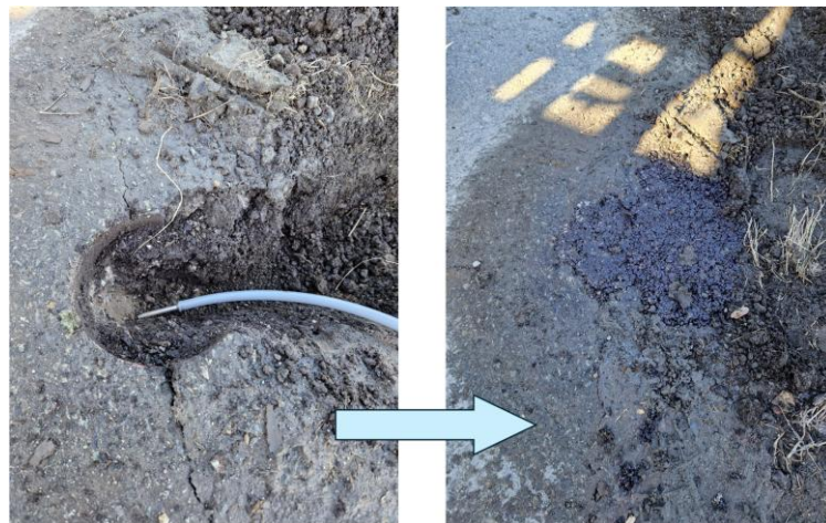
Figur 3. Temperatursensor installert i en dybde på 3 cm midt i asfaltdekket
