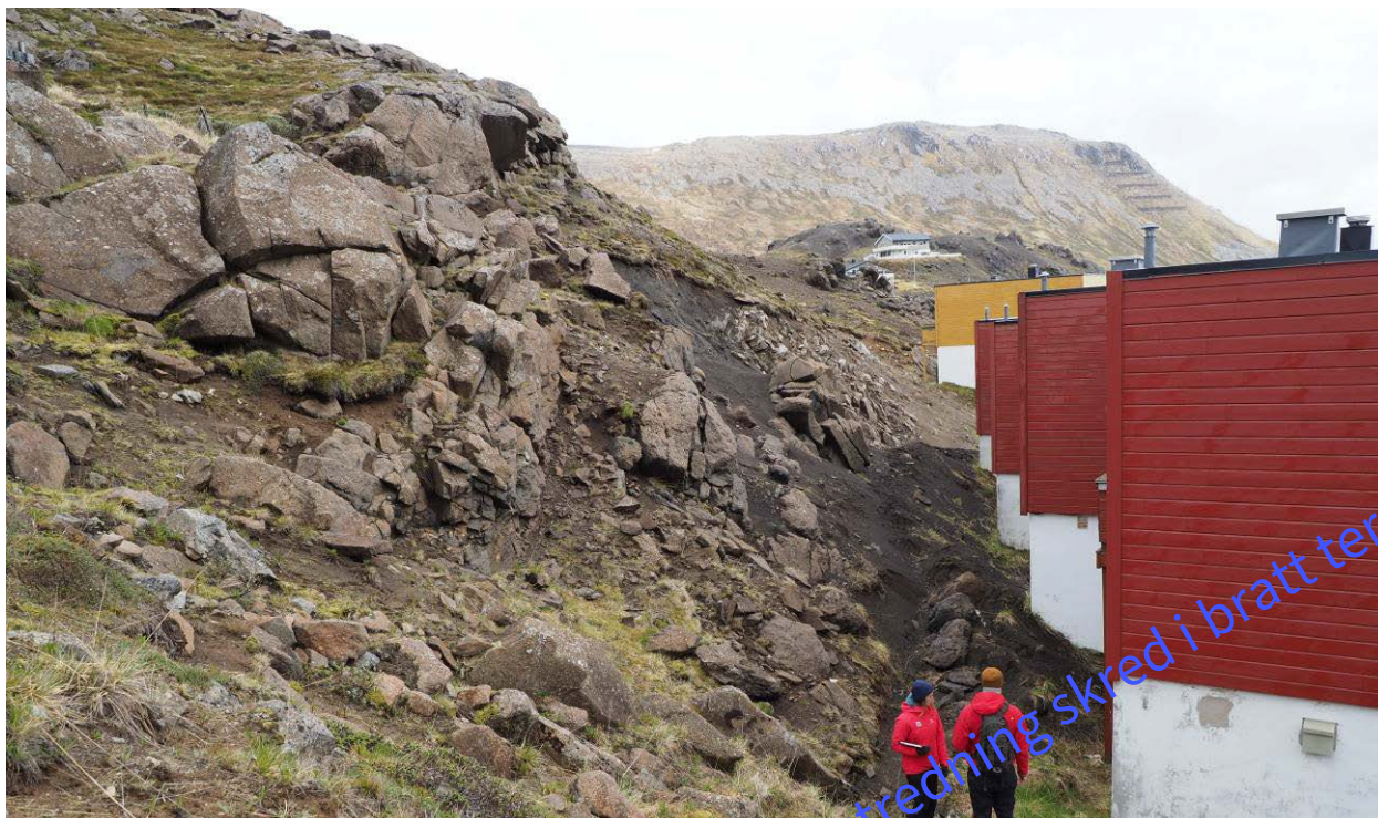
Figur 1: Skrent bak Førstevannsveien 23-29. Bilde tatt fra nord.
