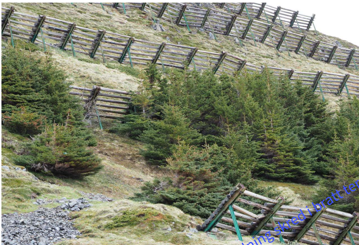
Figur 24: Støtteforbygningene over Øvre St.Hansvei. Disse begynner å bli gamle, og en bør vurdere fornyelse.
