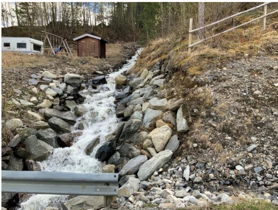
Figur 1-17 Sørlig bekk med stor hastighet på løsmasser, plastring utført. Krysser Skrangellivegen ved Lia.
