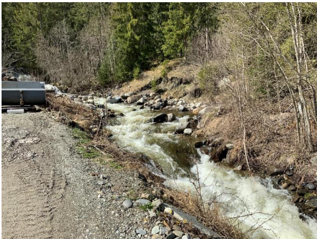
Figur 1-12 Skurdalsåa ved Holom, noe stein plassert for sikring, erosjon i høyre bredd.
