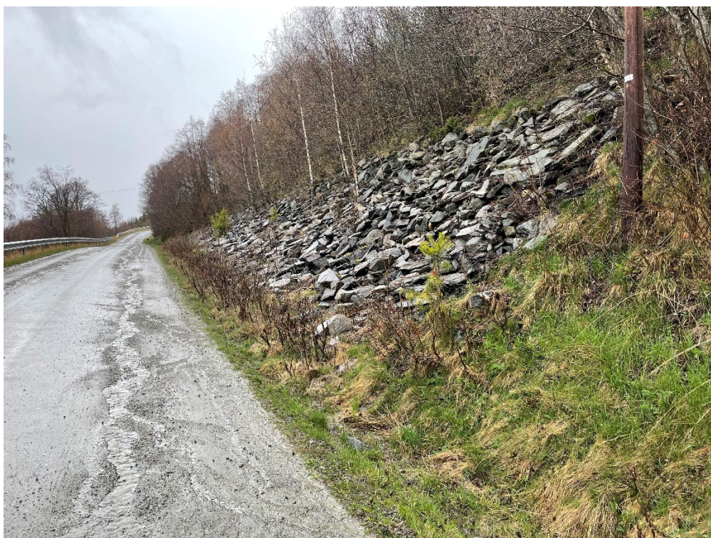
Figur 1-7 Høyere skjæringer i jord som gled ut. Ligger som skredhendelse i NVE base.
