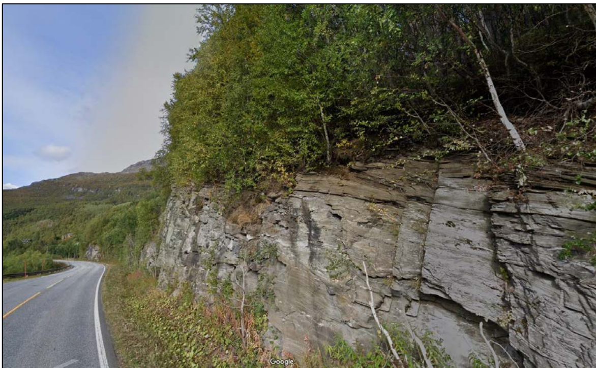
Figur 54: Oppsprekking/skifrihet i glimmerskifer ved skjæringer langs vei [12].
