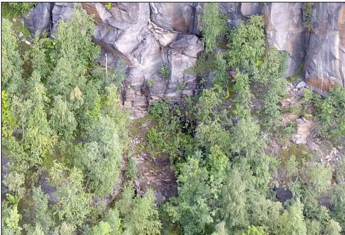
Figur 50: Skiferbergarter i nedre del av Ørnfloget har tett oppsprekking, slik at utfall herifra vil bestå av mindre blokker eller flak av varierende tykkelse.
