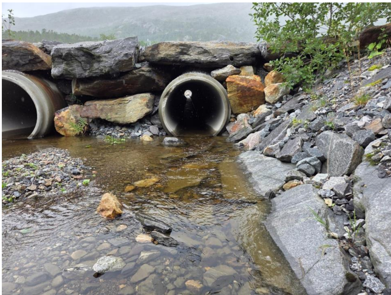
Figur 5-4: Betongrør fører Oselva under jernbanen ved Reitan leir. Betongrørene er ikke godt nedgravd, slik at vannstrengen gjennom røret blir grunn og er vanskelig for fisk å passere ved lav vassføring.
