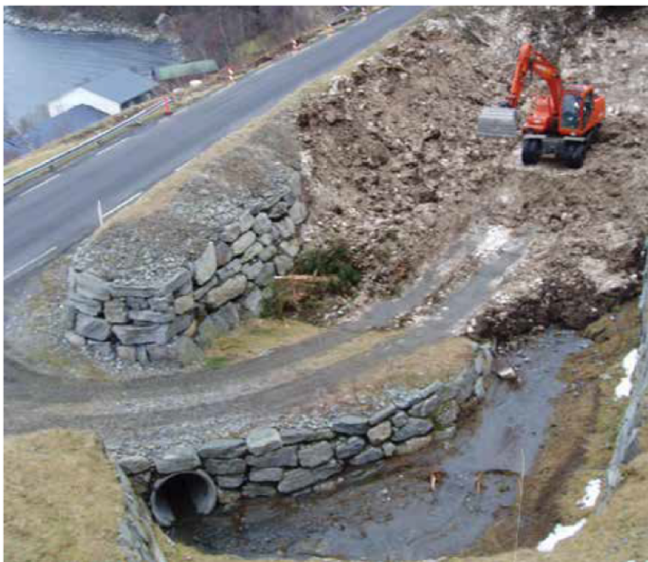
Figur 7.4.2.5—1 — Kombinert buet voll og fangvoll hvor innløpet til reserve stikkrenne er plassert til side for vollen og beskyttet for å bli tettet av skredmasser. E39, Storegjølet, Møre og Romsdal. Foto: Harald Norem, Statens vegvesen.
