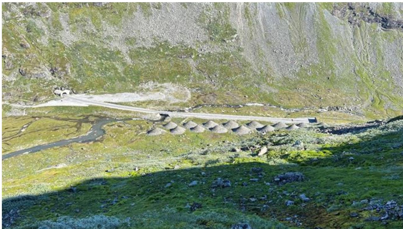
Figur 7.4.1—1 — Bremsekjegler bygget som skredsikring på rv. 15 Strynefjellet. Kjeglene er bygget nær vegen og kunne hatt bedre effekt hvis de var plassert lenger unna og mindre tett. Foto: Jeanette Gundersen, Statens vegvesen.
