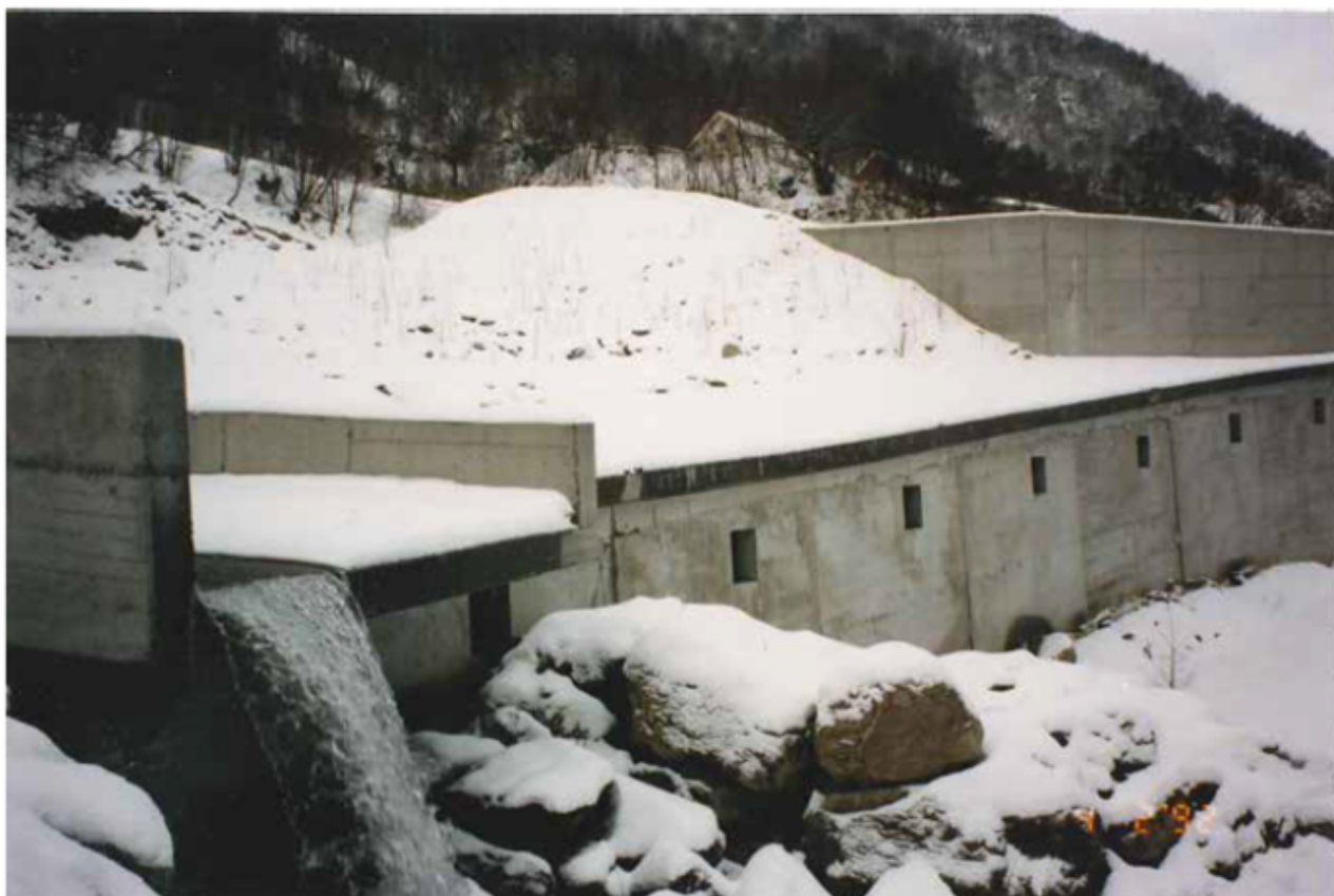
Figur 7.8.7—1 — Eksempel på skredoverbygg hvor vannet er ført over taket i en vannrenne. Området nedenfor vannrenna er erosjonssikret. Årsnesfonna, fv. 5912 Hjørundfjorden, Sunnmøre. Foto: Harald Norem.
