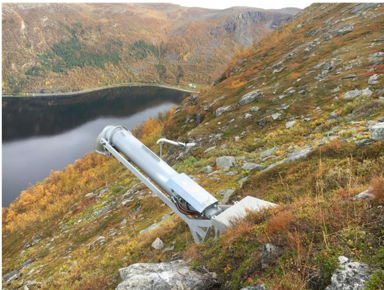
Figur 7.3.1—3 — Øverst: Gasskanoner montert i tilknytning til fv. 883 i Skillefjord i Finnmark. Nederst: Oversiktsbilde som viser teknisk bygg montert i bakkant av gasskanonene i Skillefjord. Bygget inneholder styringsenhet, batterier og gass for anlegget. Foto: Heidi Bjordal, Statens vegvesen. (fortsetter)
