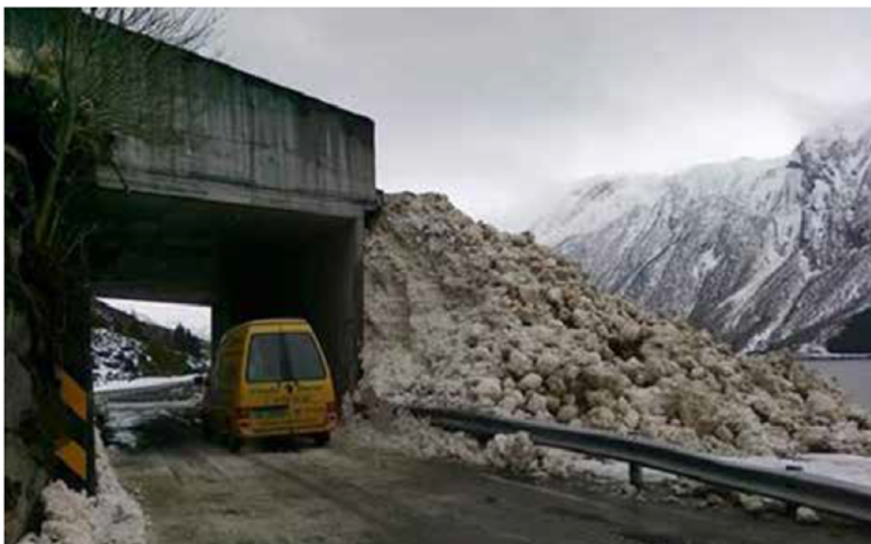
Figur 7.8.6—2 — Kort overbygg hvor skredmassene har blitt stuvet opp mot terrenget utenfor og sperret vegen. Fv. 5912 Remegjølet i Hjørundfjorden, Sunnmøre. Foto: Arnold Hustad, Statens vegvesen.
