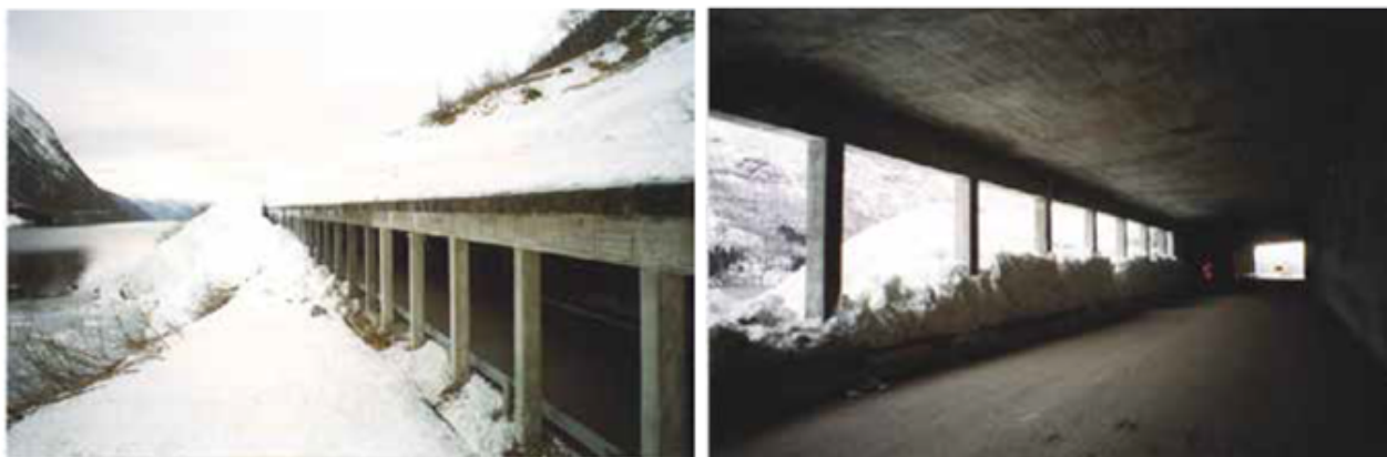
Figur 7.8.4—1 — Skredoverbygg med åpen frontvegg hvor skredsnø har trengt inn i overbygget. Fv. 613 Ramsteina Sogn og Fjordane. Foto: Statens vegvesen.
