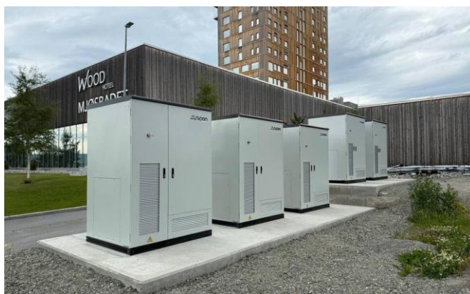
Bilde 1. Et 1 MW batterianlegg ved Mjostårnet i Brumunddal. Anlegget er installert sammen med solceller og lynladere, og skal blant annet bidra til å bedre samspillet mellom lokal solkraftproduksjon, lagring og forbruk. Foto: Suniqon
