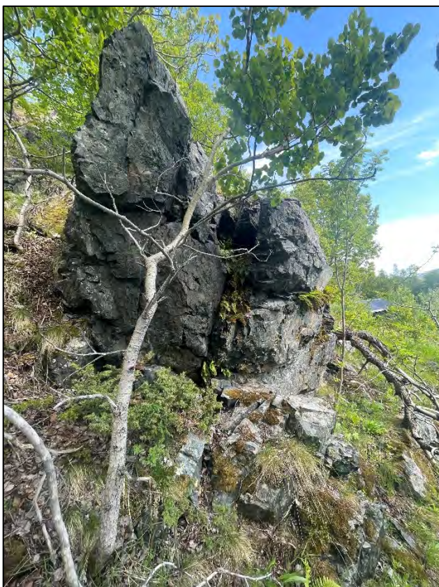
Figur 23: Avløste blokker, mulighet for remobilisering i skråningen bak Basnjarga nr. 29
