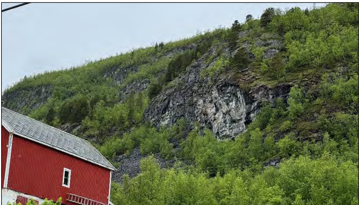
Figur 8: Løснеområder for steinsprang i nordlige del av området.
