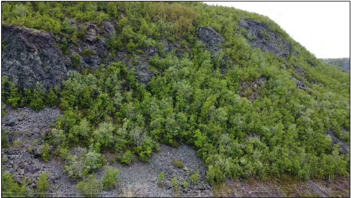
Figur 4: Bildet viser bergskrenter, løsneområder for steinsprang i nordlige del.
