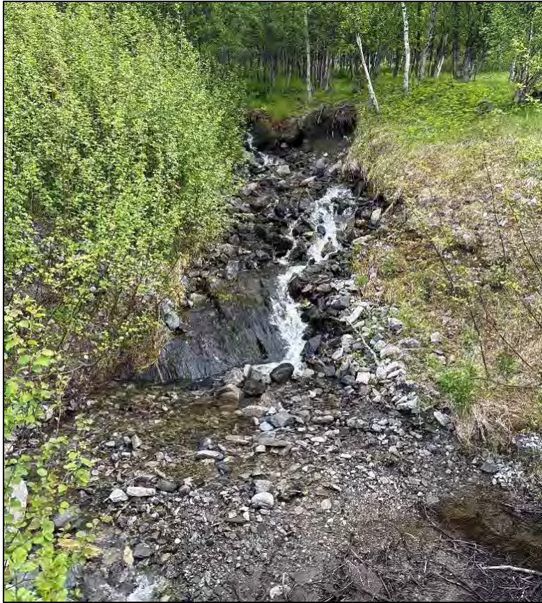
Figur 7: Bekk nordøst for Storelva viser tegn til noe erosjon langs med sidekantene og løsmassetransport. Bildet ser opp mot løpet og er fra oppsiden av E6.
