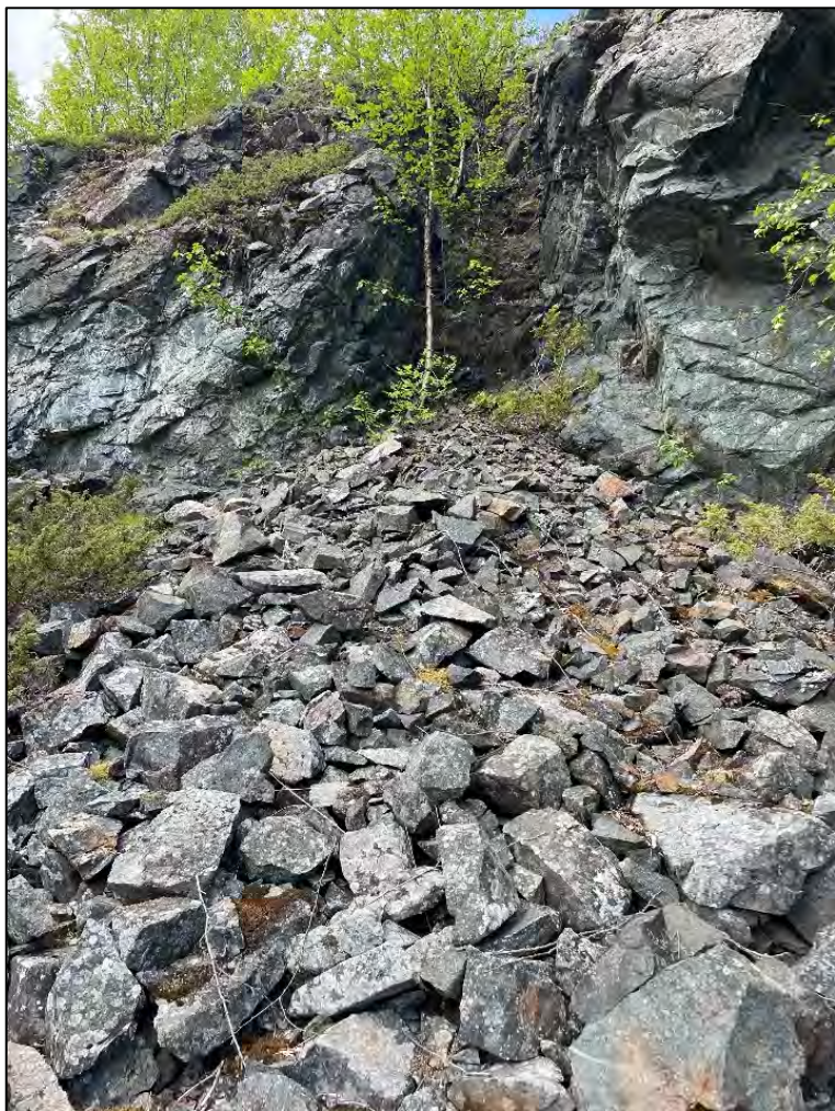
Figur 13: Bildet viser steinsprang- og forvittringsur nedenfor skrent i midtre/nordlige del av området 15-25 moh.
