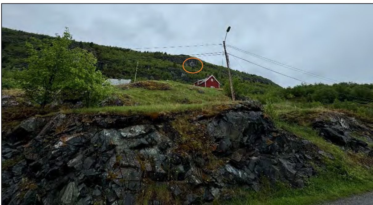
Figur 6: Bildet viser vegskjæring i nordlige del av kartleggingsområdet, og løsneområde for steinskred i øvre del av fjellsiden.
