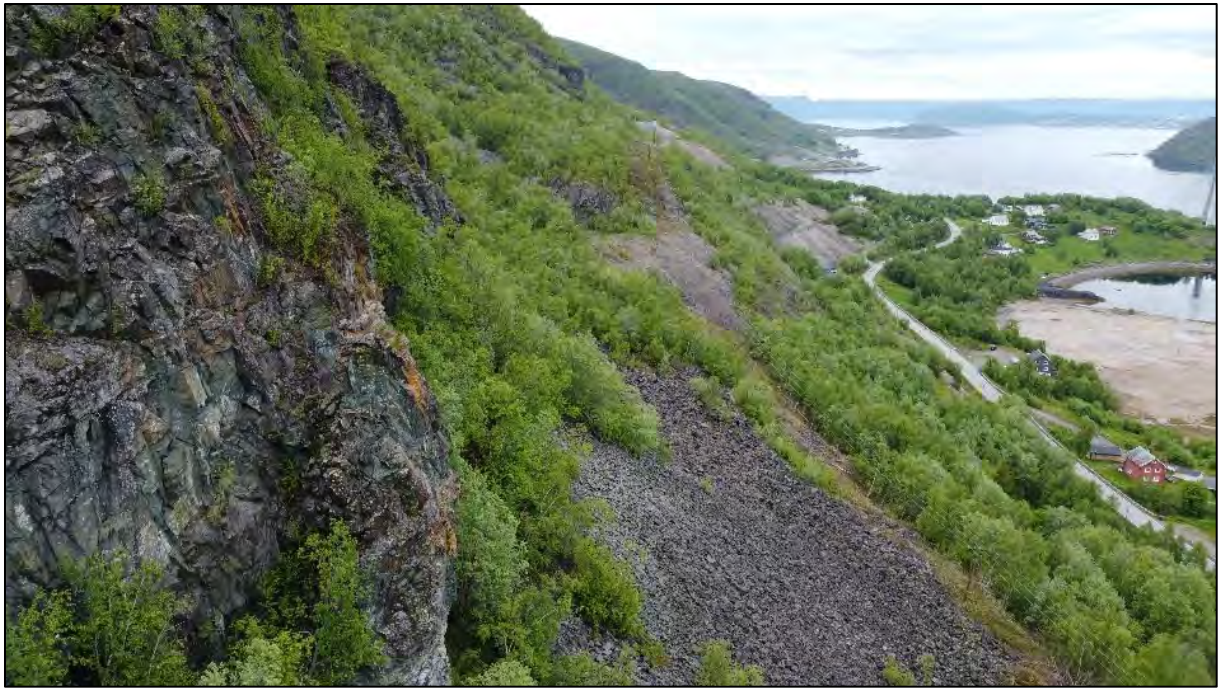
Figur 6: Løsneområder i for steinsprang i nordlige del, sett mot nord
