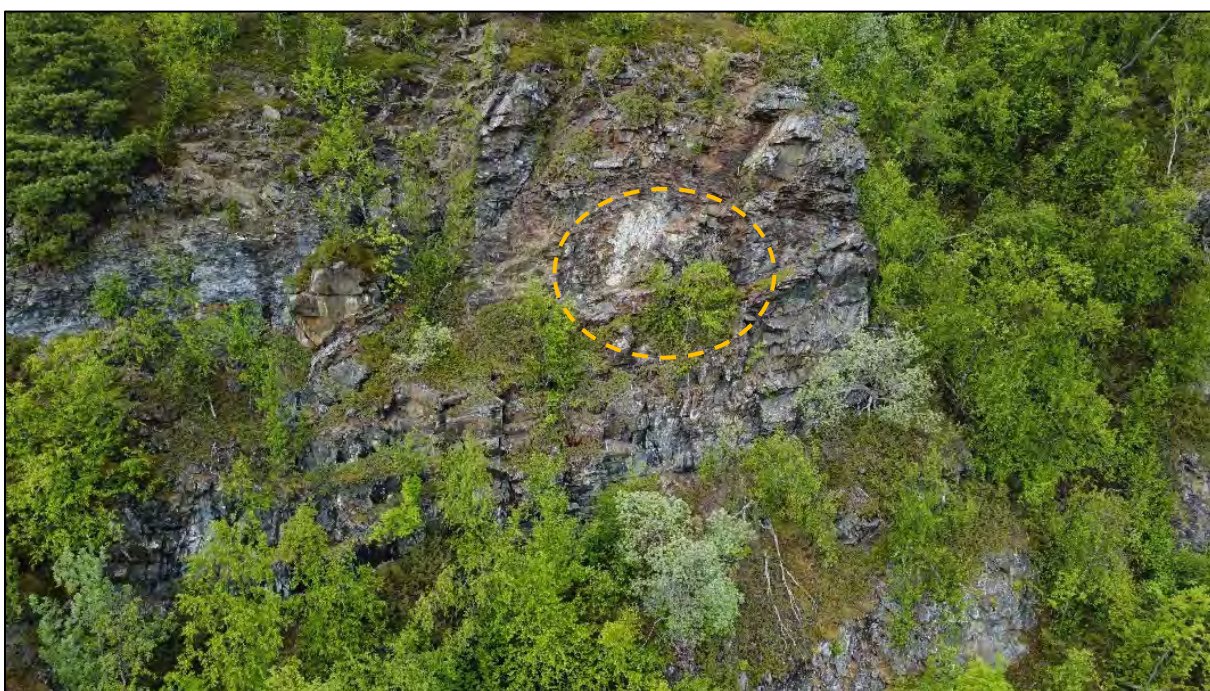
Figur 8: Deler av løsneområdene for steinsprang i midtre/sentrale del av påvirkningsområdet. Tegn til relativt ferske utfall i midtre del.
