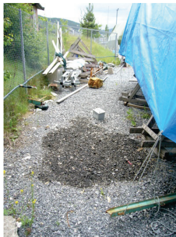
Figur 6.6 Avfall på opplagsplass
