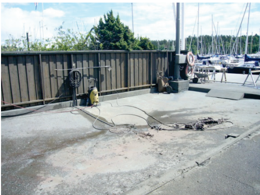
Figur 4.5 Spyleplass med sandfangskum (B1)
