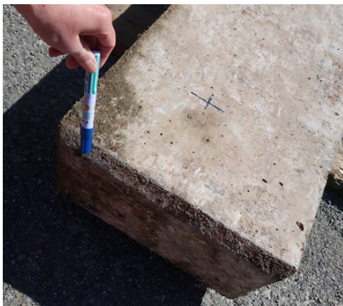
FIGUR 8 AVFASEDE KANTER MOT BUNNFLATE AV ELEMENT F1, G1 OG H1 (ELEMENTER STØPT I FASE II). FOTO: EVA RODUM, STATENS VEGVESEN
