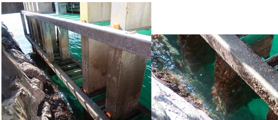
FIGUR 4 ELEMENTER I RAMMESYSTEMET FOTOGRAFERT VED PREDIKERT FJÆRE 26/4-22 (KL 14:49). FOTO: EVA RODUM, STATENS VEGVESEN
