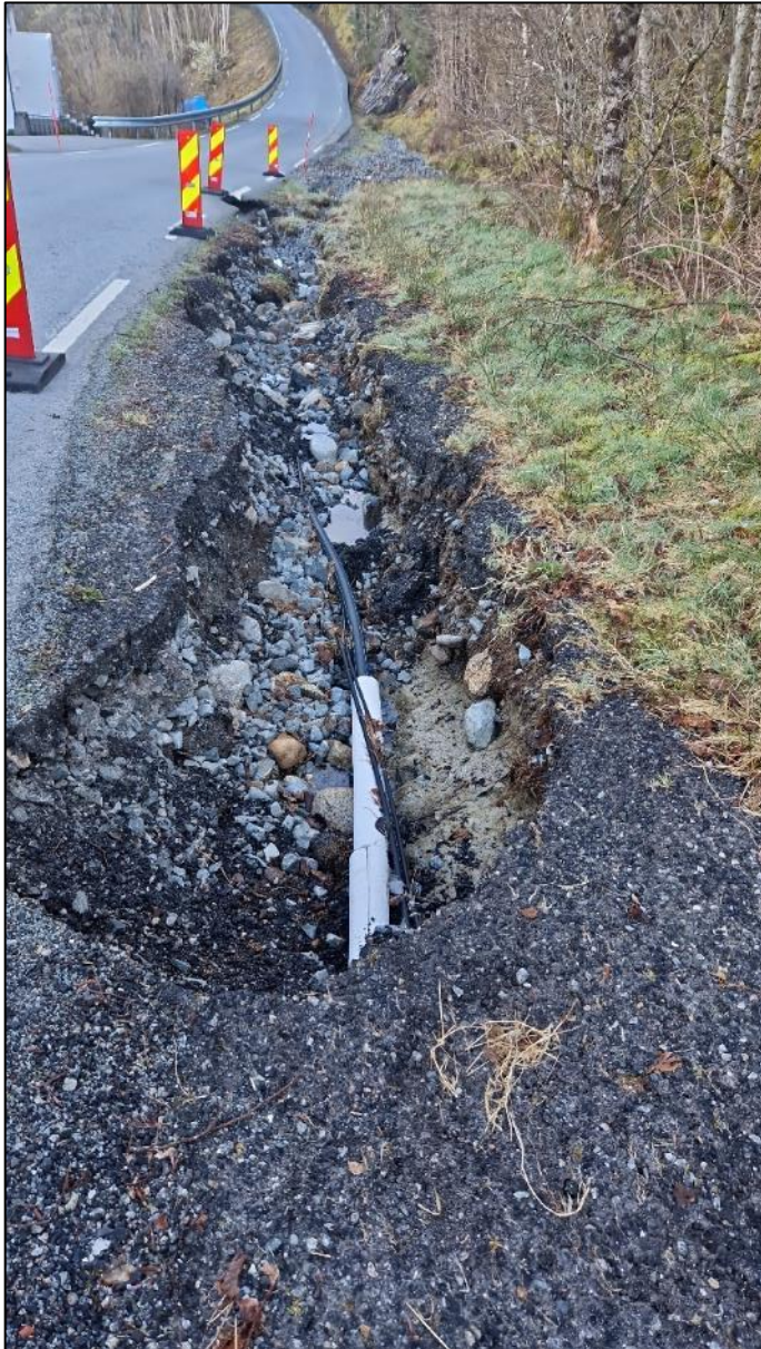
Bilde 19. Erosjon i grøften ved østlig side Nesvegen, øst for Nesvegen 147.
