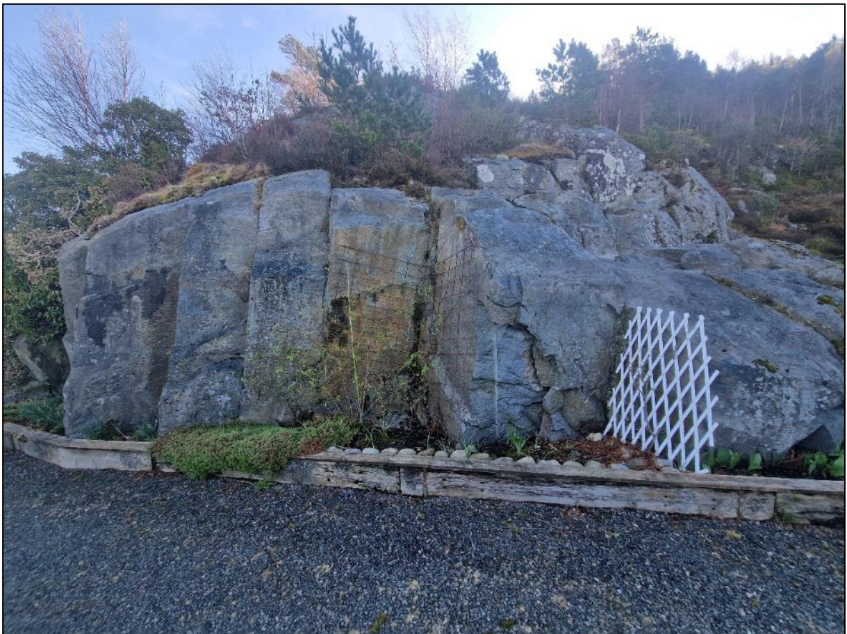
Bilde 24. Bergskjæring på adkomstvei til Nesvegen 96. Flere vertikale sprekker normal til fjellsiden vises. Bildet er tatt mot øst.
