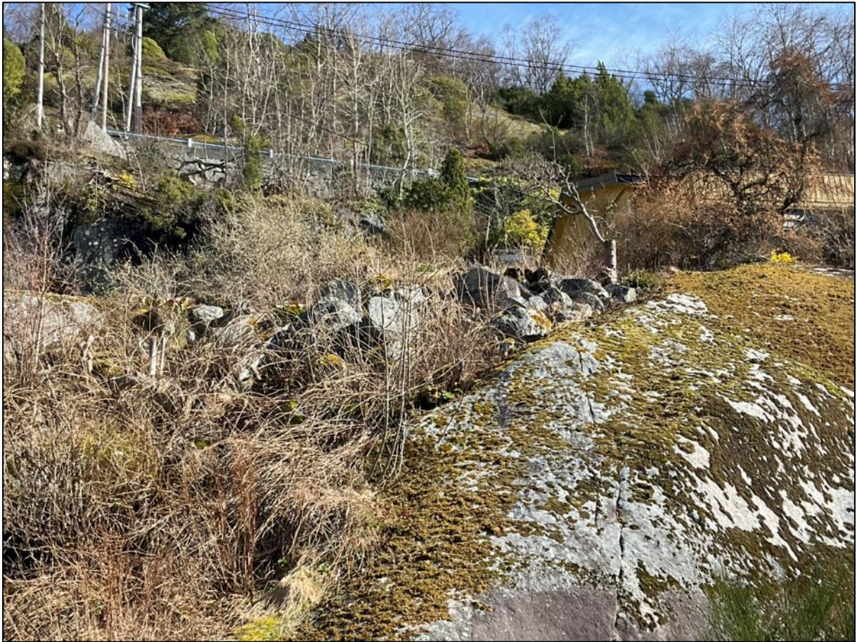
Bilde 26. Potensielt ustabil fylling. Også vist på Bilde 27. Plassering vist av infopunkt 15.
