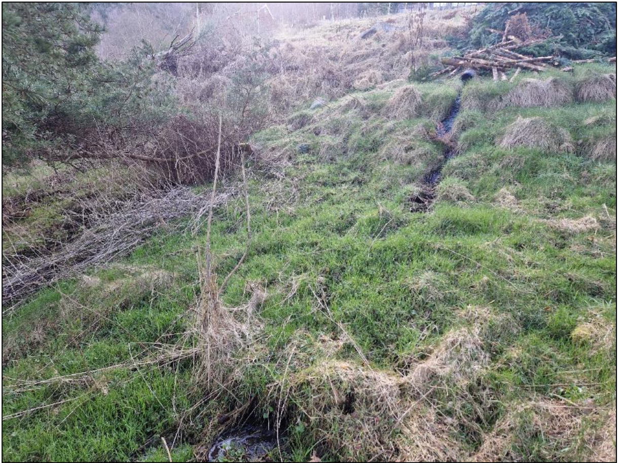
Bilde 9. Bløte løsmasser nedenfor Nesvegen på Tønnevikstølen. Krypdeformasjon observeres på overflaten. Bildet er tatt mot sør.
