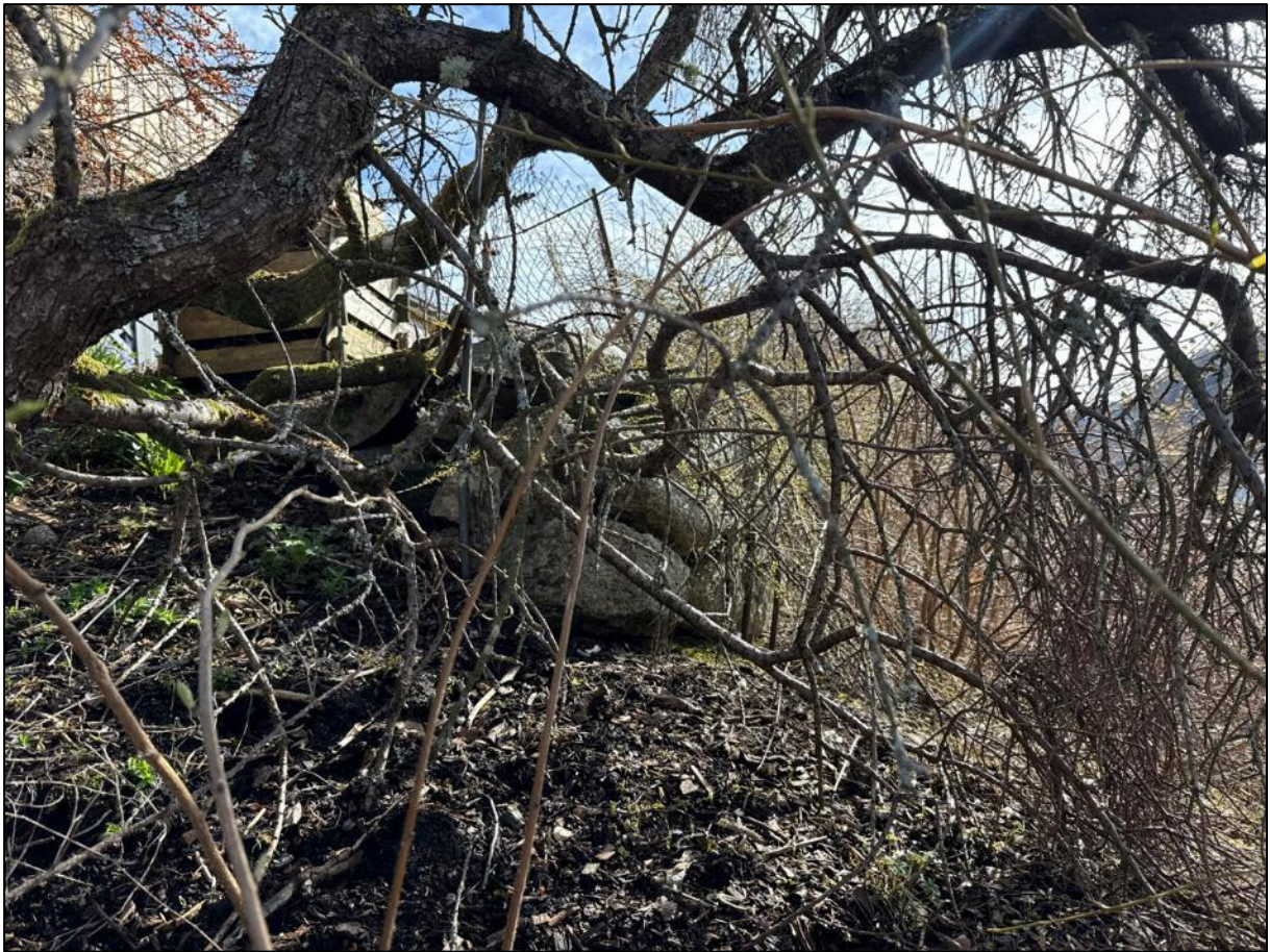
Bilde 28. Stabilede blokker i topp skrent forsøkt sikret/festet med svartstål. Plassering på nedsiden av Burmavegen 56, vist av infopunkt 19.
