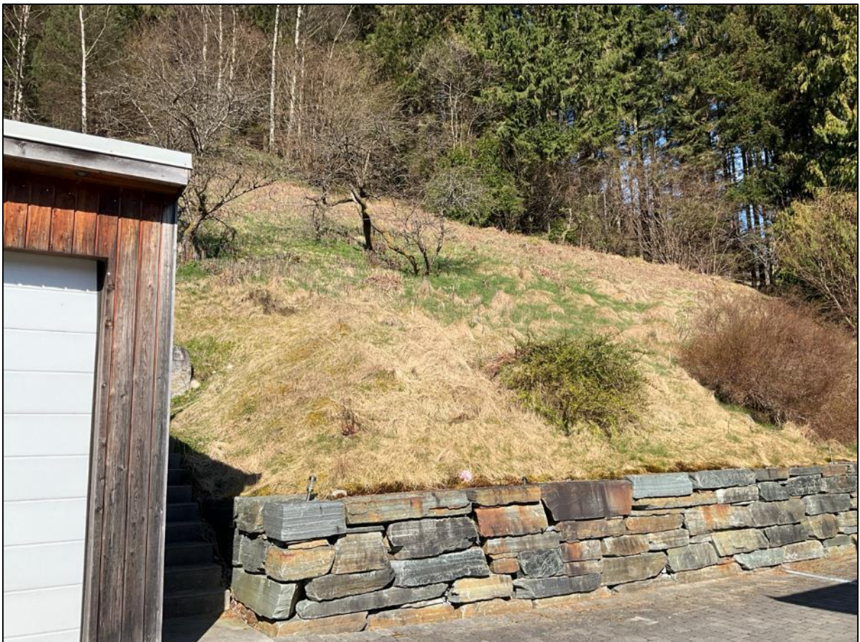
Bilde 10. Sørvendt skråning i løsmasser ved Ryfylkevegen 5484.
