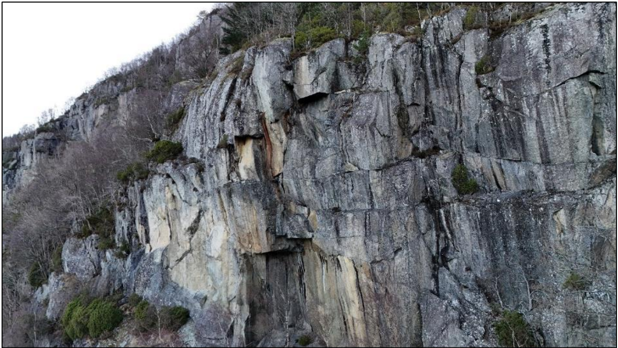
Bilde 9. Oppsprekking i fjellvegg opp mot Høgeknuten. Steile baksprekker (eksfoliasjonssprekker) og subvertikale sprekker som avgrenser sideveis, samt et tilnærmet vertikalt sprekesett som fører til øvre og nedre avgrensning. Bildet er tatt mot øst.
