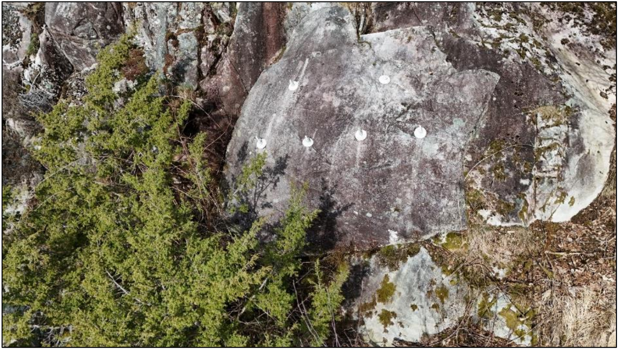
Bilde 30. Boltesikring i terrenget ovenfor Nordbygda 74 og 77. Markert av infopunkt 3.
