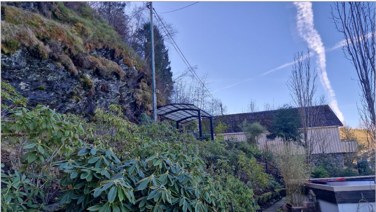
Figur 78. Bergskrent bak hus på Hundsnesvegen 102.
