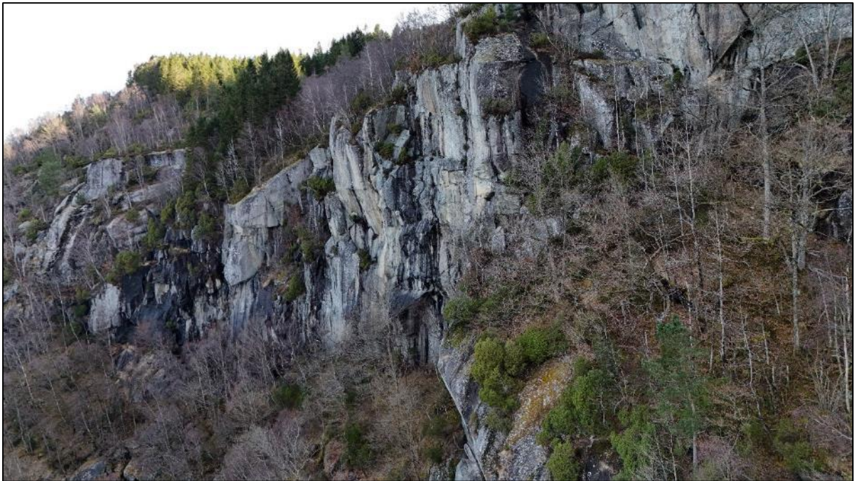
Bilde 12. Oppsprekking i fjellvegg opp mot Høgeknuten. Bildet er tatt mot nordøst.
