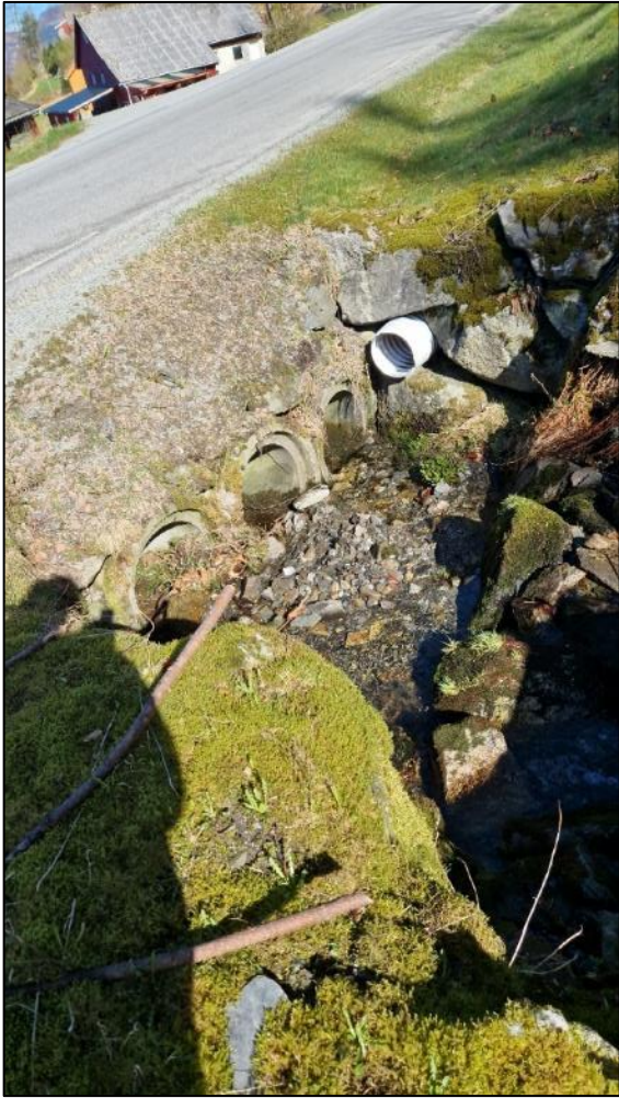
Bilde 18. Basseng og rør på øvre side Hundsnesvegen ved historisk jordskred fra 1871.
