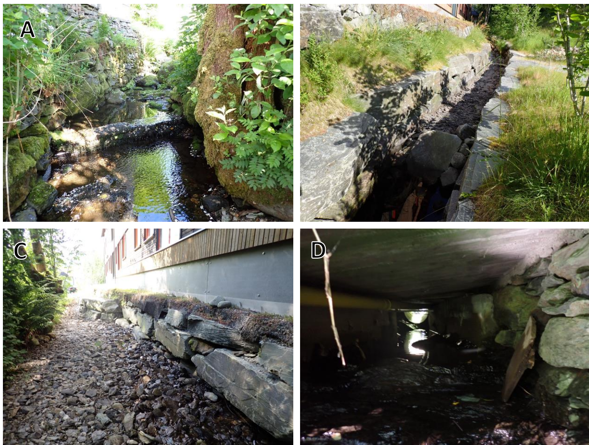
Figur 40. Inngrep i Reistadelva: A) Kanalisert og forbygd strekning i segment 1, flere steder oppover krysser det rør over elven. B) og C) Kanalisert og forbygd strekning uten kantvegetasjon nede og oppe i segment 3, elven går tørr når vannføringen er lav. D) Øverst går elven i rør og kulvert under en bygning.
