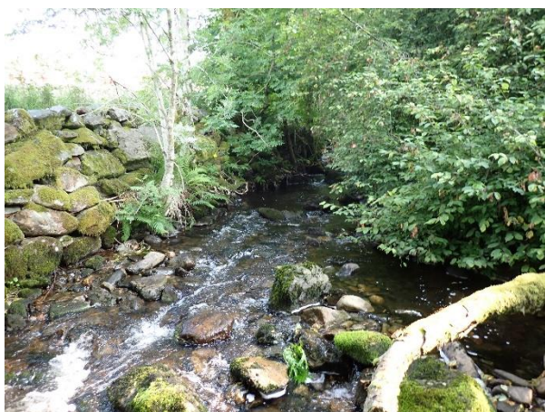
Figur 60. Morfologiske inngrep i form av forbygning i segment 1, Nordvikvassdraget.
