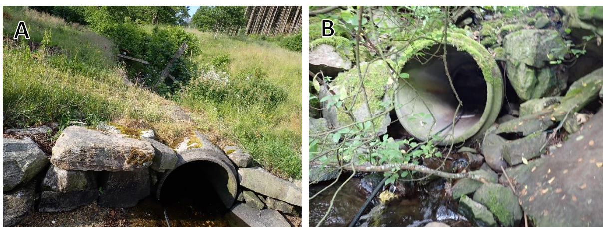
Figur 67. Vandringshindre og bekkelukkinger: A) Kort rør ved sjøen som er lett å passere. B) Røret under Botnagrendavegen ligger tørt ved lav vannføring, og er sannsynligvis svært vanskelig å vandre opp gjennom på høyere vannføring.
