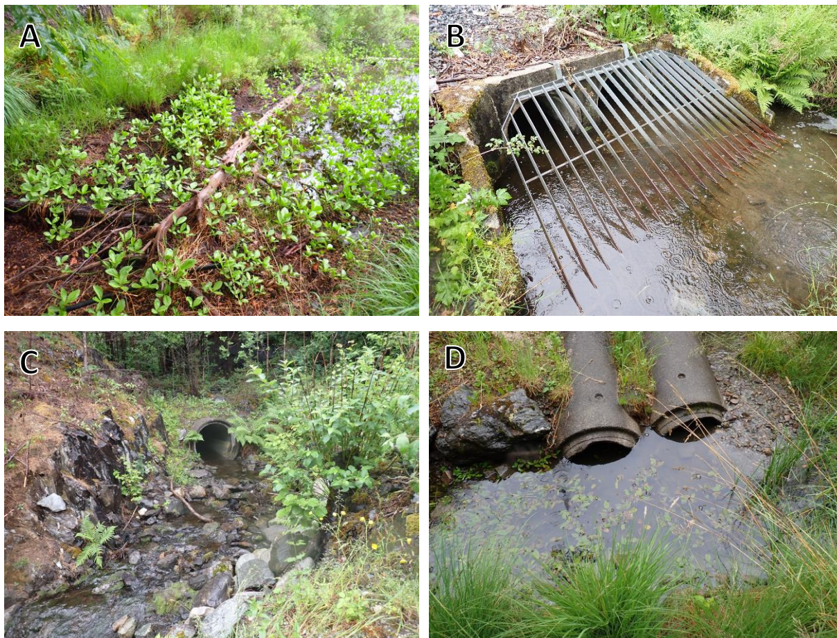
Figur 16. Vandringshindre og bekkelukkinger: A) Elven renner diffust gjennom tilgrodd myr i segment 20, det er ikke mulig for fisk å passere på lave vannføringer. B) Rist oppstrøms det lange røret mellom segment 4 og 5. C) Røret mellom segment 11 og 12 er greit for fisk å passere gjennom D) Også røret under Halhjemsmarkavegen er enkel å passere.
