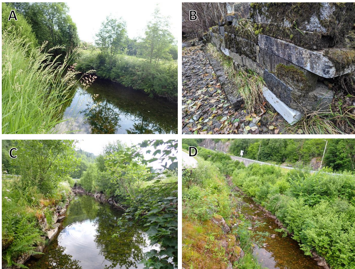
Figur 45. Morfologiske inngrep i Ådlandselva: A) Manglende kantvegetasjon i segment 2. B) Forbygninger med kasserte gravsteiner i segment 4. C) Utrettet elvestrekning med forbygninger og glissen kantvegetasjon i segment 8. D) Forbygning og manglende kantvegetasjon i segment 9.
