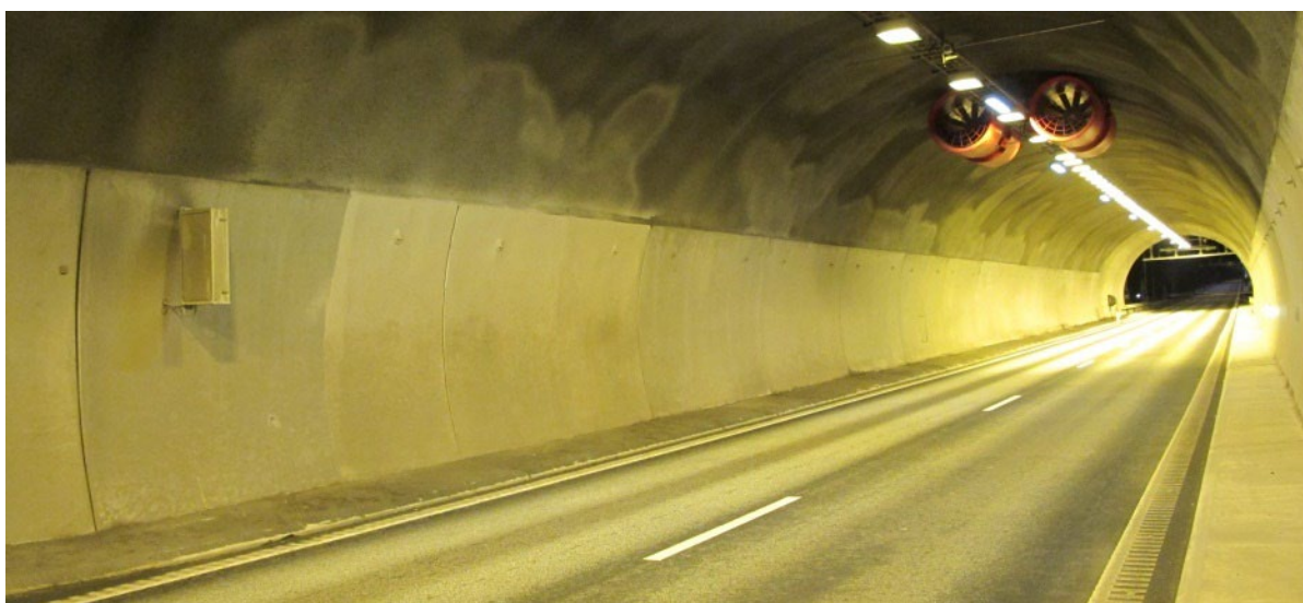
Figur 7 Oversikt – fra element nummer 15 – før vask juni 2011. Foto: Eva Rodum, Statens vegvesen.
