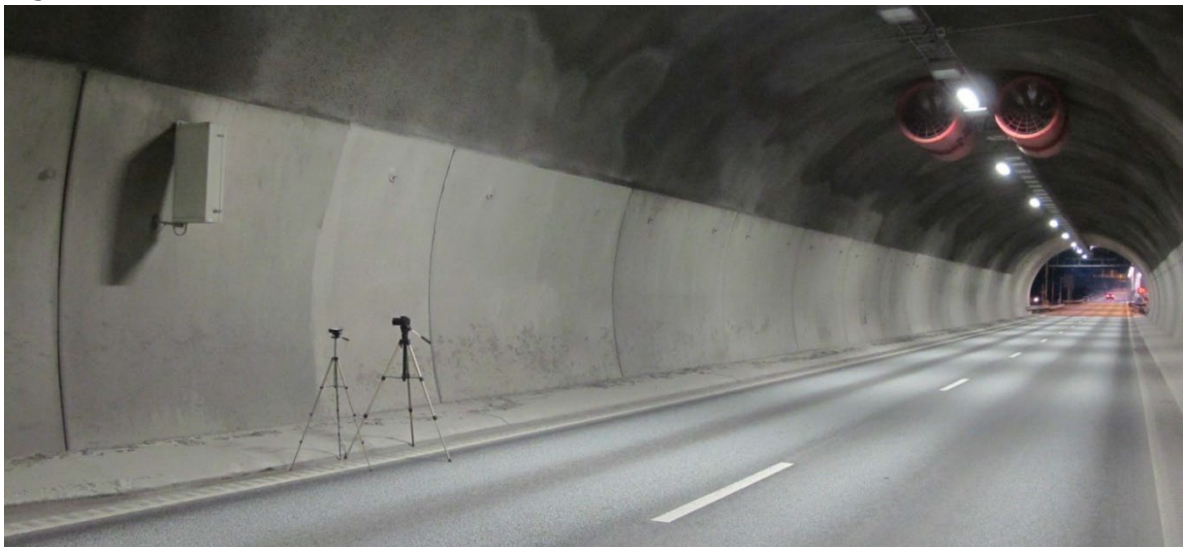
Figur 9 Oversikt – fra element nummer 15 – før vask april 2013. Foto: Eva Rodum, Statens vegvesen.
