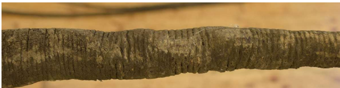
Figur 64 (foto: HFS) Kledningen på spleisen oppe lå ikke tett og det er en god plass å sjekke for å se etter ytterligere rust.
