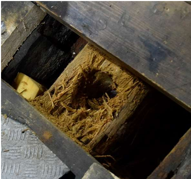
Figur 10 Sjøfartsdirektoratets inspektør krevde alle gjennomføringer ut for å se til at det ikke var tæring i dem eller i tømmeret. Rundt sjøvannsventilen var det "lutråte" i spantet.
