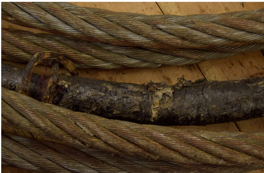
Figur 63 (foto: HFS) Staget hadde noe overflaterust, men ikke faretruende. Kledningen nede hadde en del skader og trengte å bli byttet.
