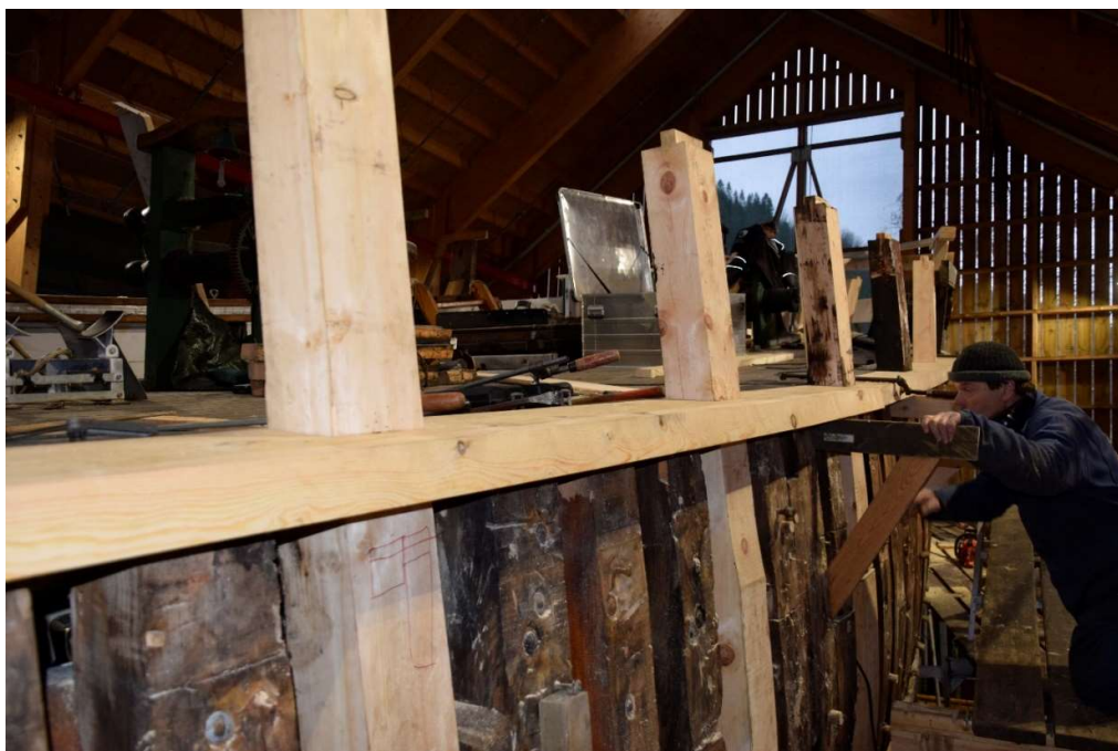
Figur 18 Terje Skorpen i gang med å lage et par nye biter skandekk. Her ser vi at det er skiftet ut en hel del rekkestøtter på styrbord side. Rundt rekkestøttene er en typisk lekkasjeplass, og derfor var det råteskader i både skandekk og rekkestøtter.
