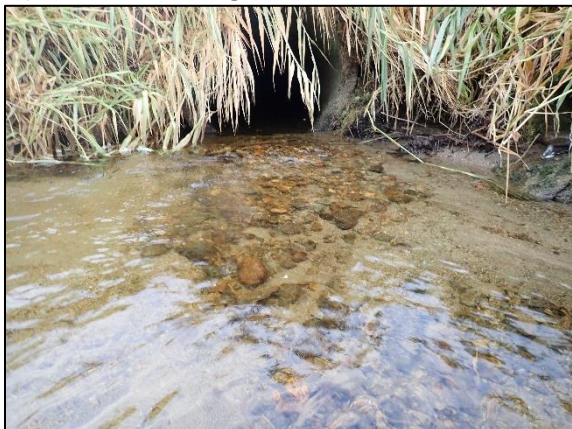
A) Rør nederst i segment 27
