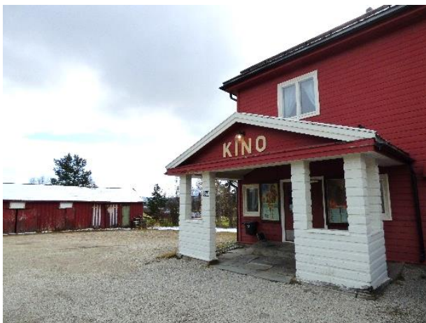
Det utvendige inngangspartiet til kinoen har sunket noe ned, slik at vann fra taket ledes i feil retning. Inngangspartiet bør rettes opp og skadet panel skiftes ut.
