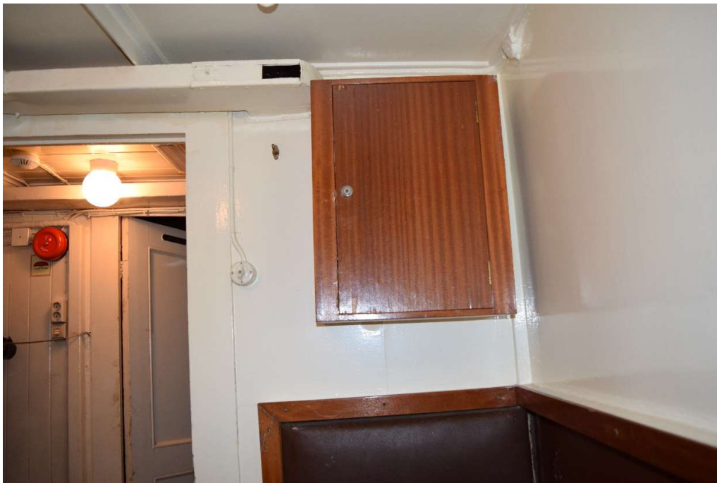
Figur 59 Foto Aarskog elektro I kok/styrmannslugar før demontering i 2015.
