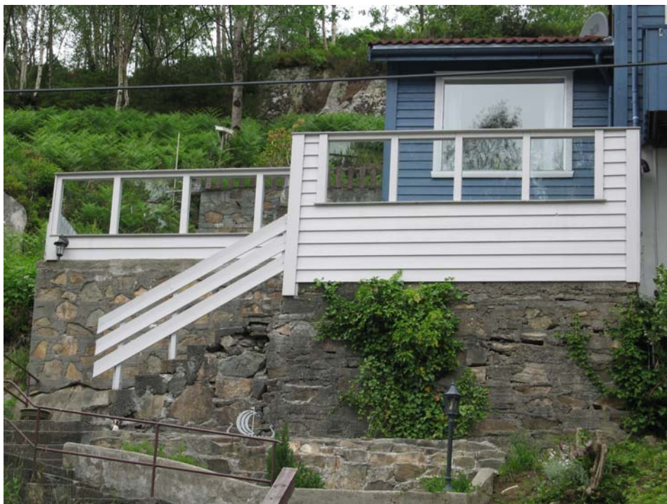
Figur B.4: Bergen, Sædalsvegen 132. Skjerm på terrasse. Det kan se ut som om en har benyttet samme type skjerm (samme glassformat og samme innfesting) både for Sædalsveien 132 og 150. Utformingen virker lite gjennomarbeidet selv om en i materialbruk og fargevalg har prøvd å ta opp noen elementer fra den eksisterende bygningsmassen.
