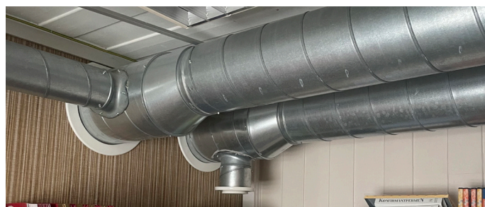
Bilde 16. Ventilasjonsføringer i tak - Første etasje
