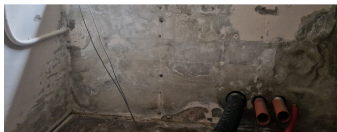
Bilde 14. Fuktskader i sørvestre rom i kjeller
