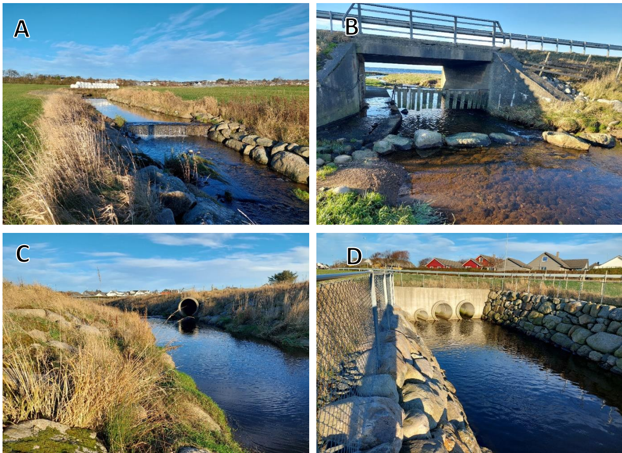
Figur 4. Vandringshindre og bekkelukkinger: A) Kunstig temporært vandringshinder i segment 16. B) Store steiner på tvers av elven i nedre del. C) Rør fra sideløpet i sørøst ligger litt høyt i terrenget i forhold til hovedelven. D) Hovedelven går i rør under tettbebyggelsen på Vigrestad.
