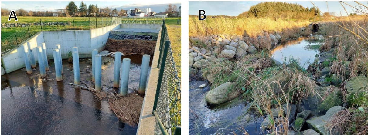
Figur 5. Vandringshindre og bekkelukkinger: A) Flomsikringstiltak i elven, nyetablert kulvert i segment 22-23. B) Store steiner lagt ut i elven for å opprettholde vannspeil, men en del steder virker disse som vandringshindre ved lav vannføring.
