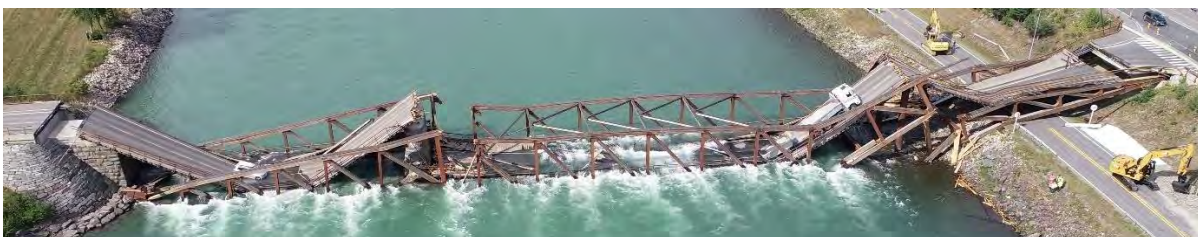
Figur 70 Tretten bru kollaps sett fra nedstrøms side.
