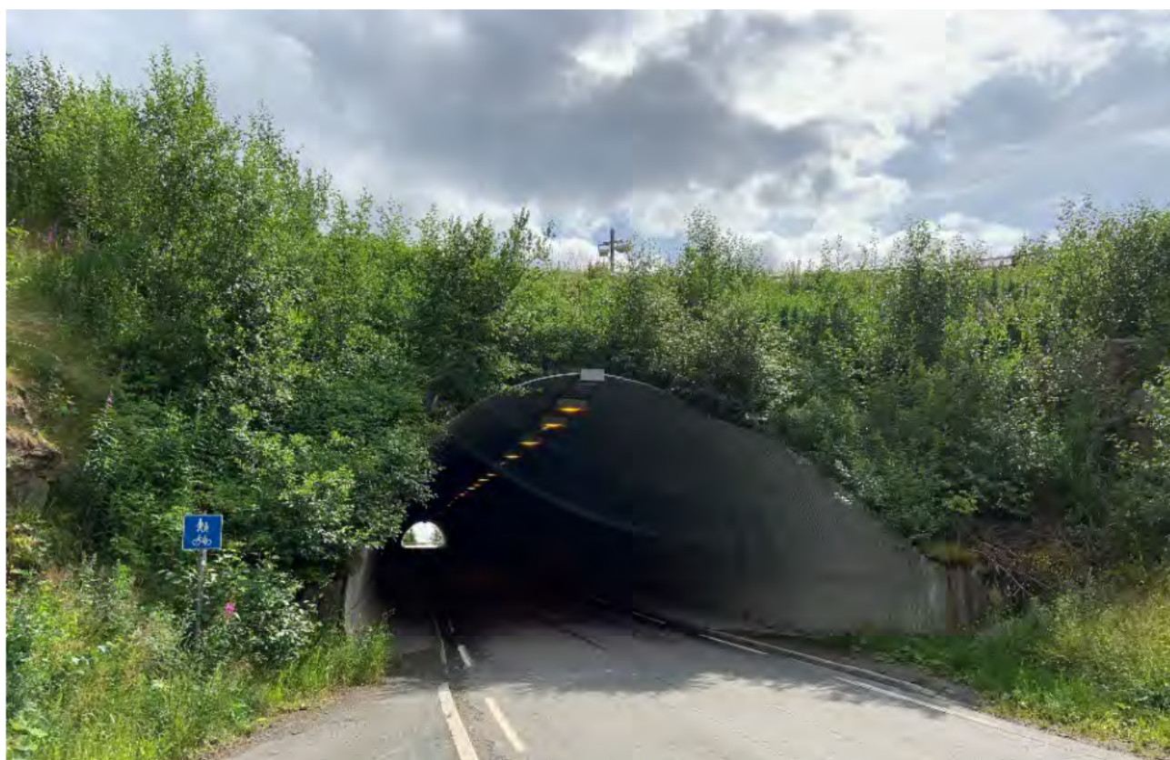
Figur 13.3.1—1 — Stort korrugert stålrør brukt som veg-gjennomføring for Fv. 2560 under Hafjell alpinsenter Foto: Veslemøy Gardå, Statens vegvesen
