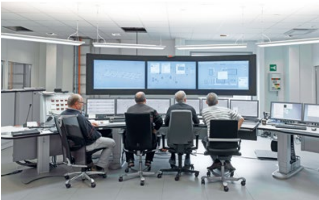
Kontrollrom i administrasjonsbygget – Teknologisenteret på Mongstad.
