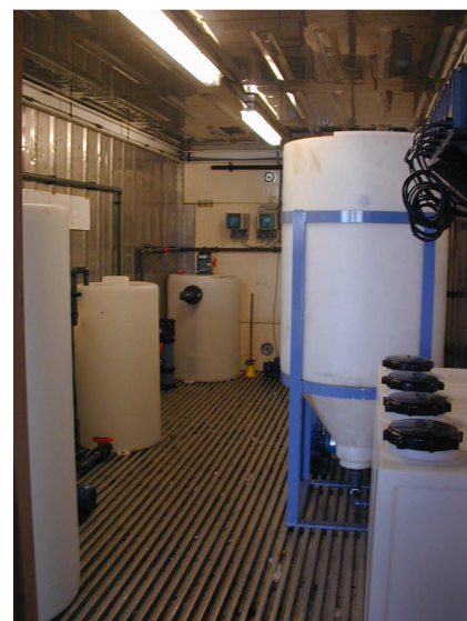
Nøytralisering og felling i pilot plant
