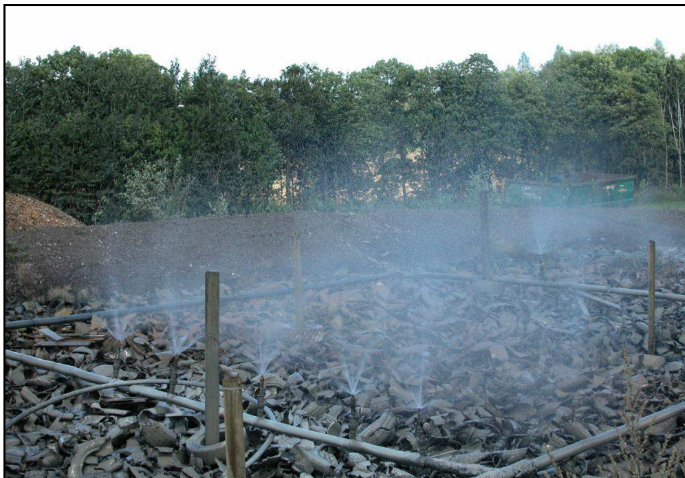
Figur 24: Fra Ragn Sells oksigeneringsanlegg for sivevann fra en industrifylling i Lier ved Drammen. Vannet eksponeres for luftas oksygen ved å pumpes ut gjennom forstøvende dyser. Effekten kan økes ved å tilsette små mengder hydrogenperoksid i innvannet.
