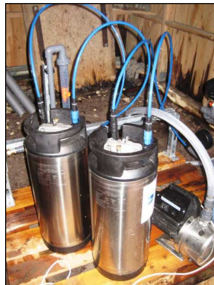
To 20-liter Silex kolonner fra pilotforsøk med selektiv ionebytte av nikkel i Karlstrup kalkgruve
