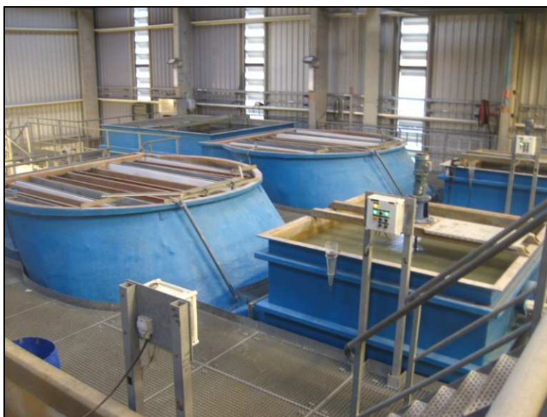
Figur 58. Renseanlegg hos Danfoss. To store lamellseparatorer (120 m 3 /h) til venstre og flokkuleringstanker til høyre. (COWI 2012)
