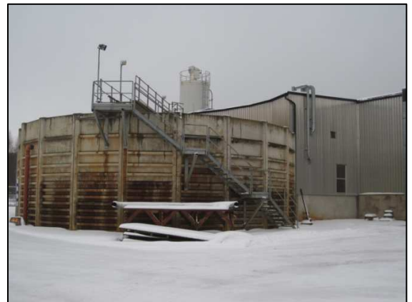
Utendørs sedimentasjonstank foran anleggsbygning
