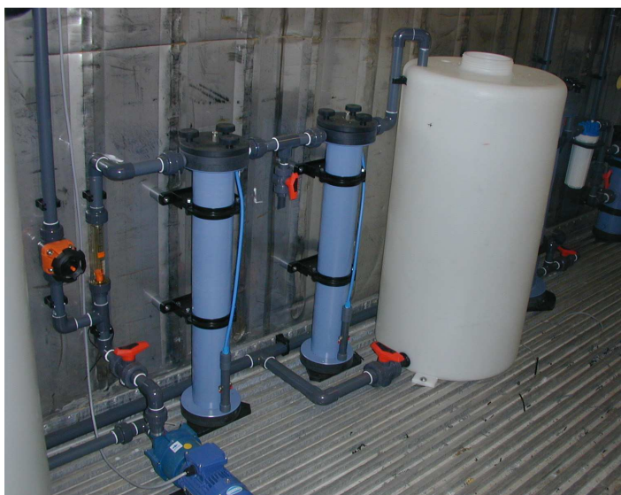
Ionebyttekolonner til selektiv ionebytte i pilot plant
