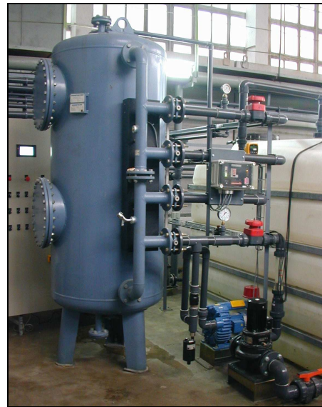
Figur 59. Hydroantrasittfilter med skyllevannspumpe
