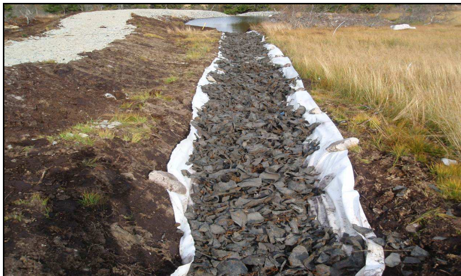
Figur 25: Forsøksanlegg for heving av pH og oksigenering av vann i Regionfelt Østlandet. Under dekk-klippen ligger det et lag med nedknust olivin. Utfelte stoffer sedimenterer i dammen i bakgrunnen.
