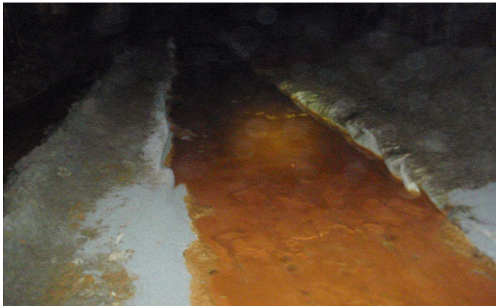
Figur 26: Reaksjonskammer i Tverrfjellet gruver. Den røde fargen skyldes utfelling av jern. I dette tilfellet er det ubehandlet gruvevann som ledes inn på reaksjonsfilteret.
