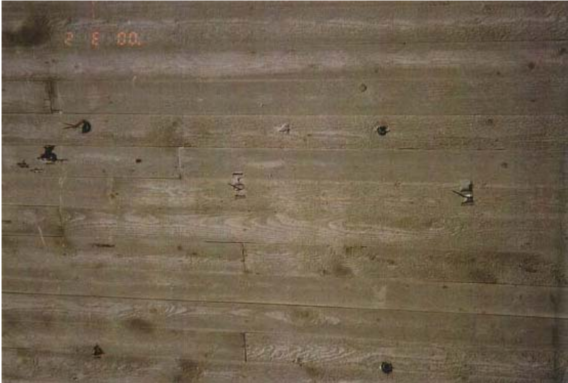
Fig. 17 Nærbilde av overflaten. Perfekt speilbilde av forskalingshuden. Bare synd at armeringsstolene av betong synes så godt
