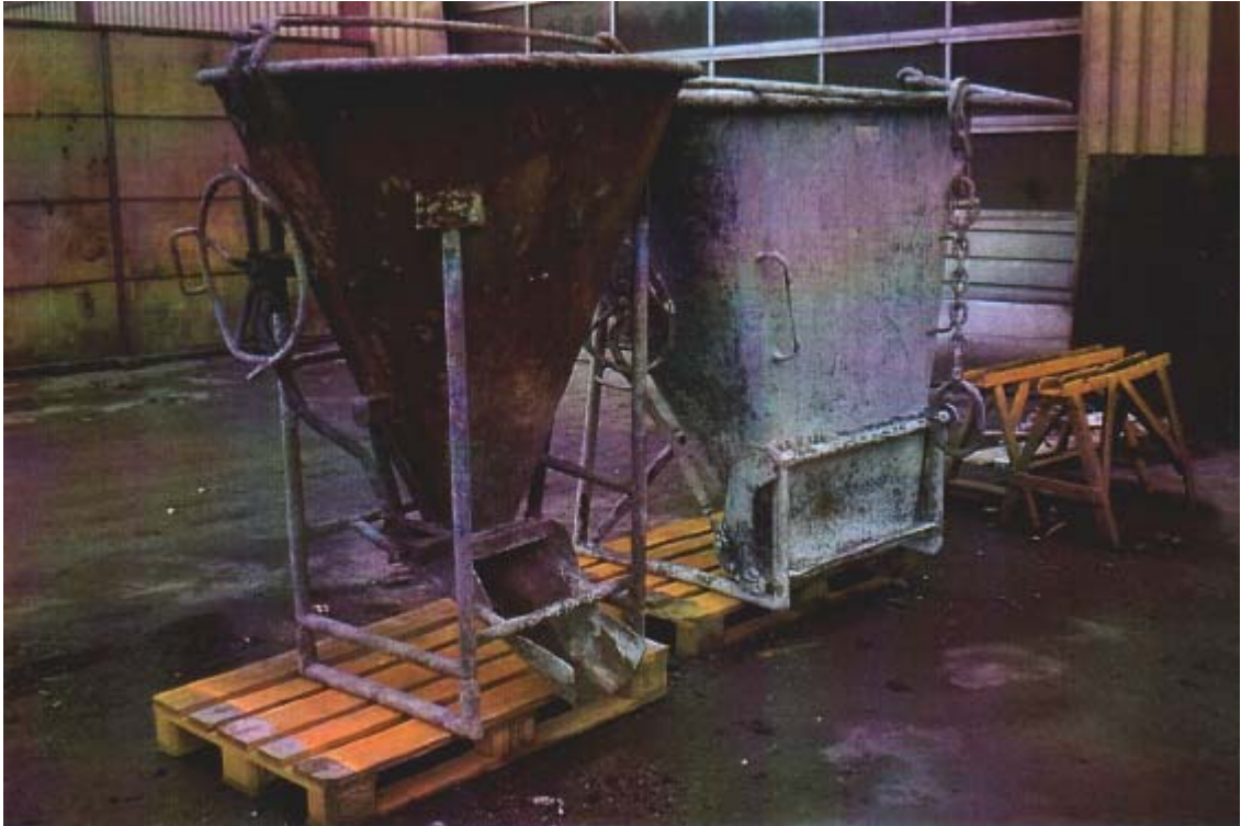
Fig. 25. Spesiell søyletobb til venstre, veggtobb til høyre.
