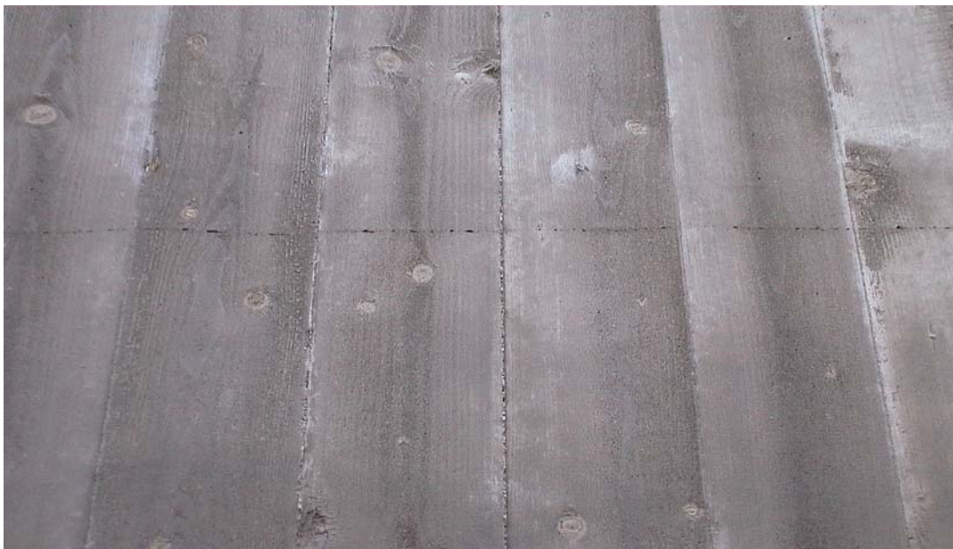
Fig. 28. Eksempel på "floender", manglende utfylling hvor bløt SKB flyter ut oppå skorpe av SKB under.
