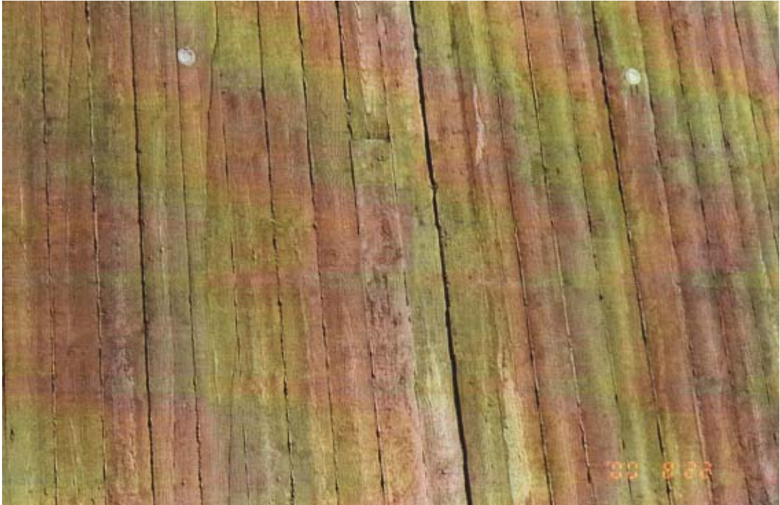
Fig. 3. Bordforskaling som har vært alt for glissen/utett. Burde vært bedre vannet før støp.
