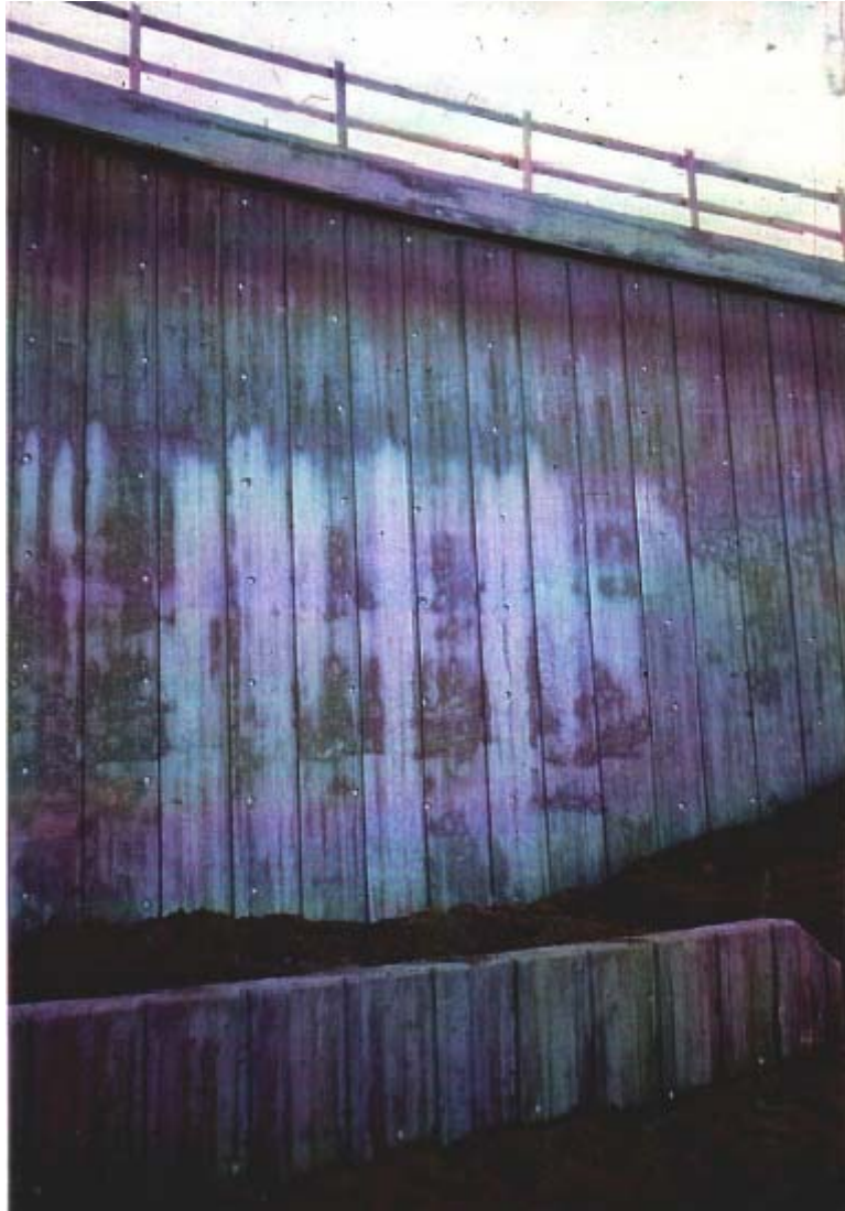
Fig. 31. Kalkutslag som følge av regnvær kort tid etter avforming. Bemerk hvordan veggen oppunder kantbjelken har vært beskyttet.
