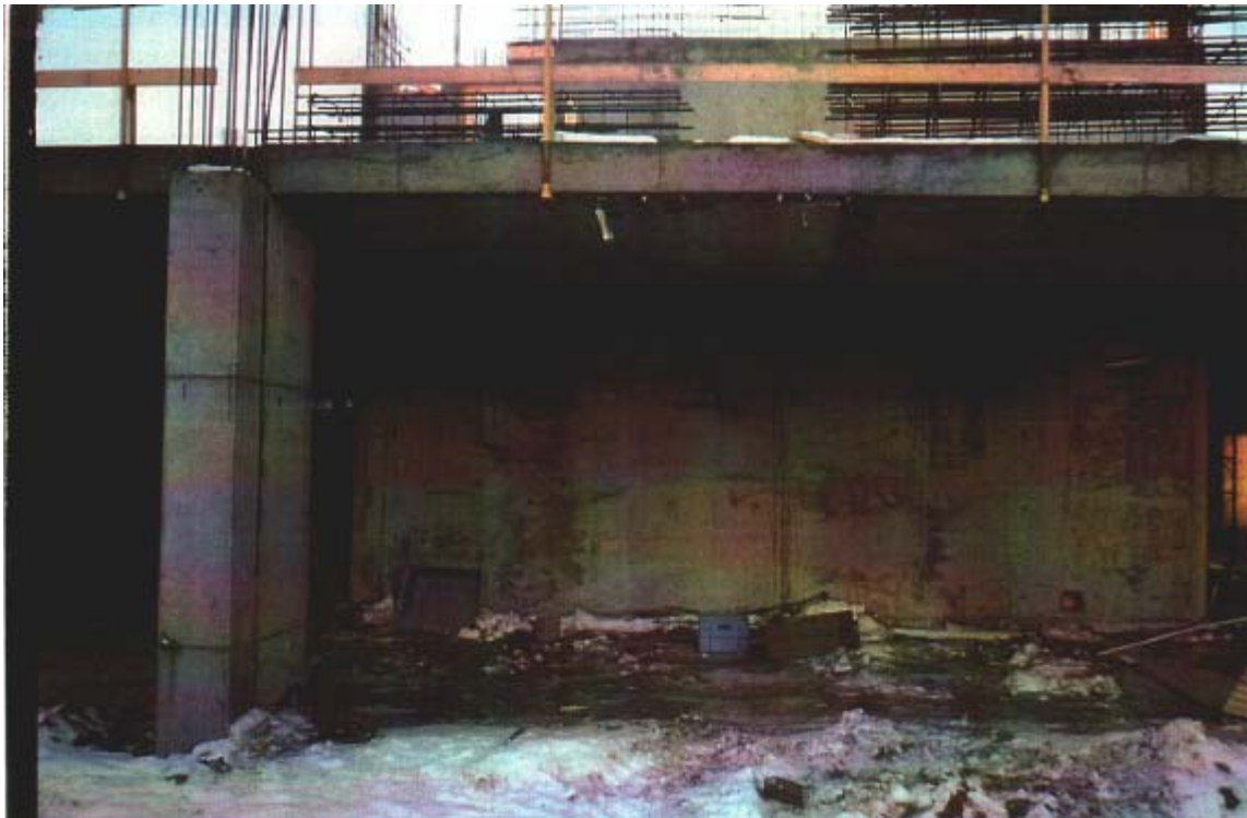
Fig. 10. Typisk vinterstøpsresultat. Skjoldete overflate pga. for tykt og ujevnt med forskalingsolje.
