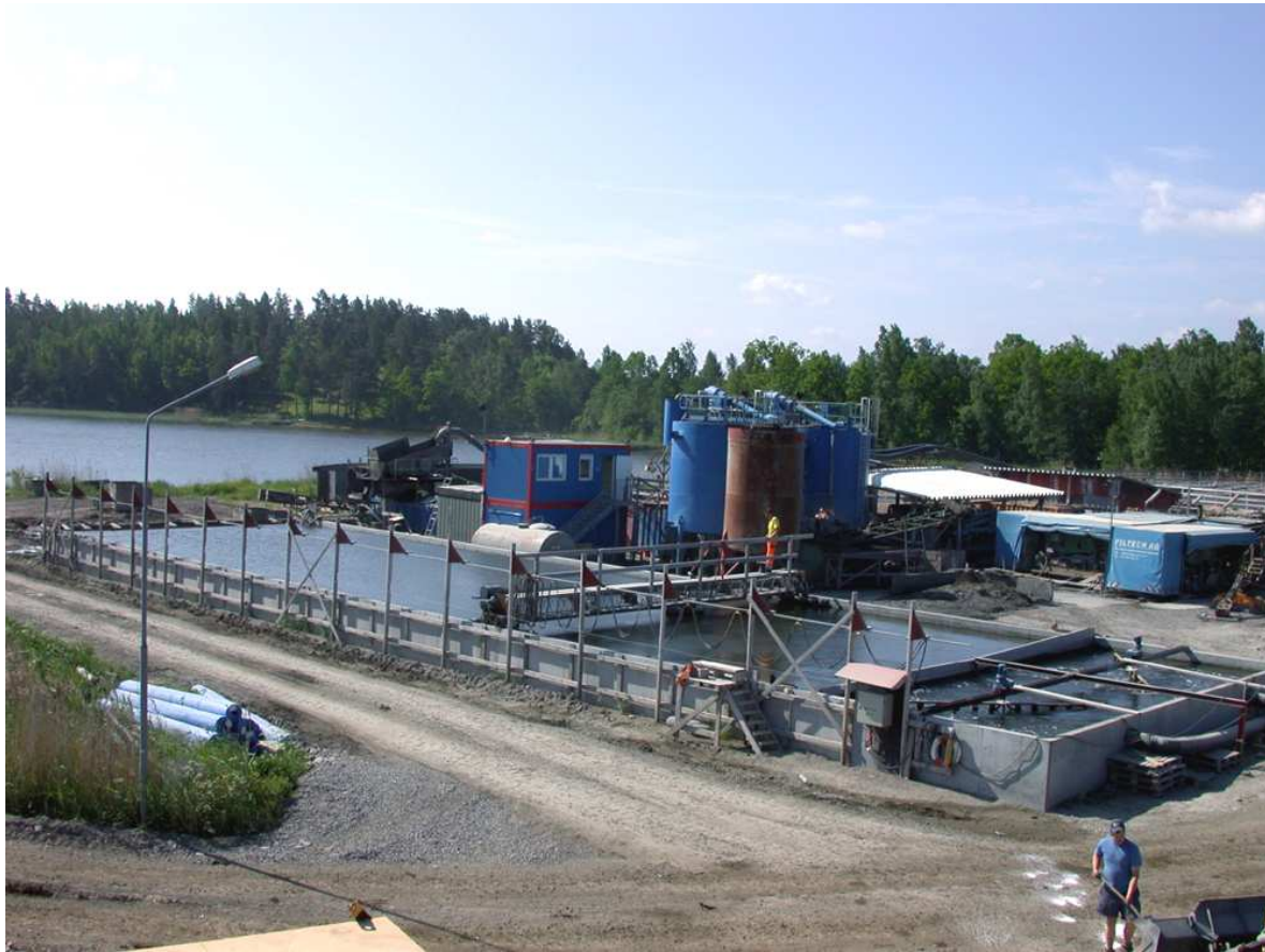
Figur 20. Avvanningsanlegg for masser mudret med horisontal auger i Örserumsviken, Sverige (Geir Arne Røstum, Rambøll)
