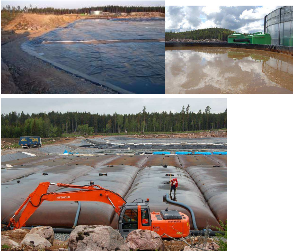
Figur 24. Prosjekt Svartsjøarna. Øverst til venstre: Klargjøring av bunn i deponiet. Øverst til høyre: Rensing av vann fra deponi. Nederst: Utplassering og fylling av geotekstilposer (fra http://www.hultsfred.se/templates/Page_2231.aspx )
