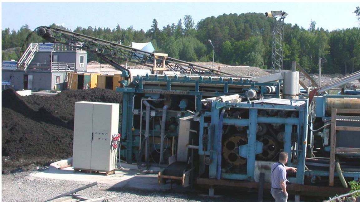
Figur 21. Filterpresse i avvanningsanlegg for masser mudret i Örserumsviken, Sverige (Geir Arne Røstum, Rambøll)
