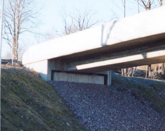
Figur 2 Ikke-ispiserbart avstand mellom endeskjørt og endeopplag (foto: Gaute Nordbotten)
