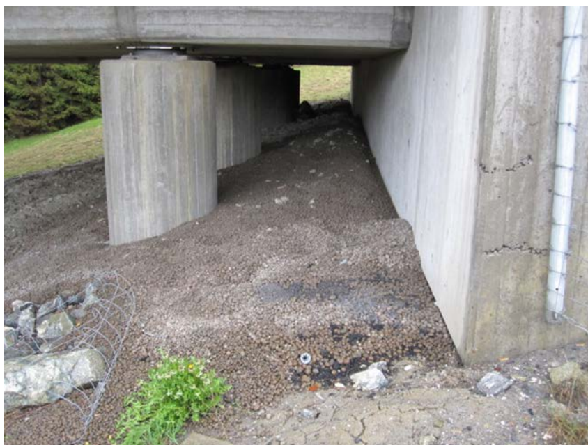
Figur 8 Mangelfull tilbakefylling (foto: Gaute Nordbotten)
