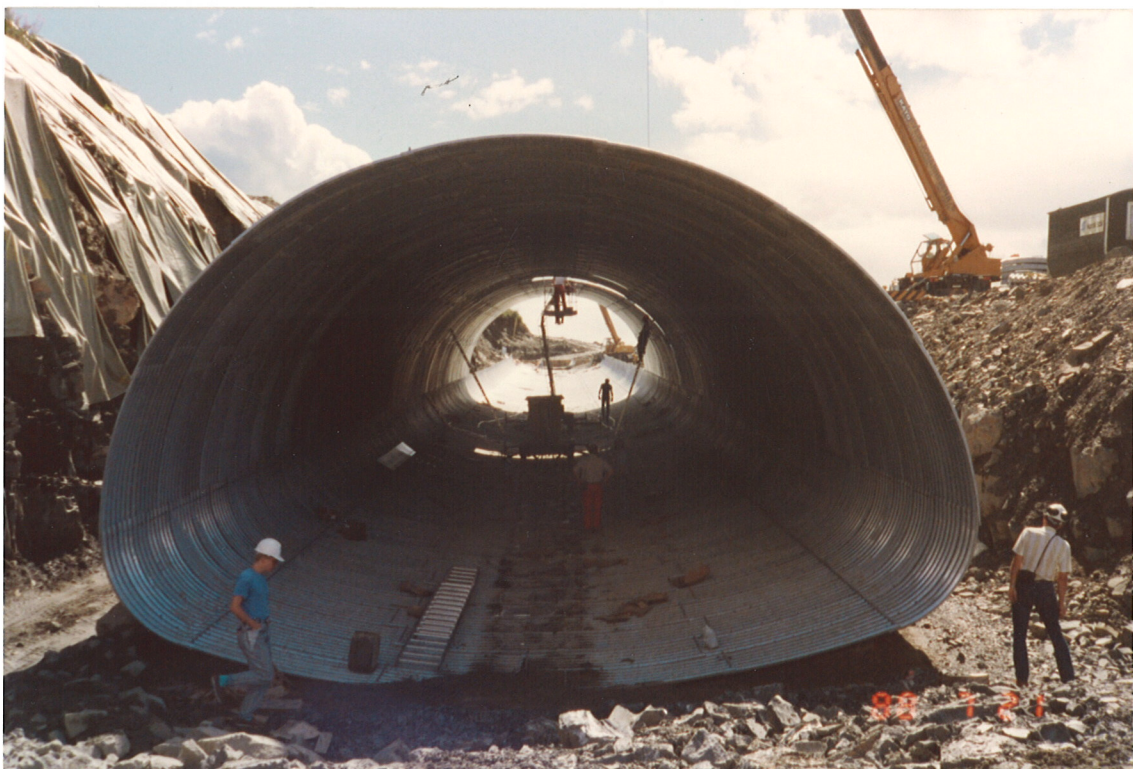
Bilde 16 Stålrør Hafjell ferdig montert. Stålrøret med diameter 9,32 m ble bygget uten langsgående trykkbjelker av betong.
