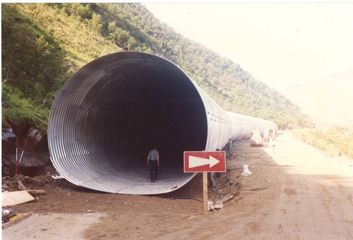
Bilde 14 Rasoverbygg Senja. Midlertidig vei på utsiden under montering. Under omfylling legges trafikken gjennom overbygget.
