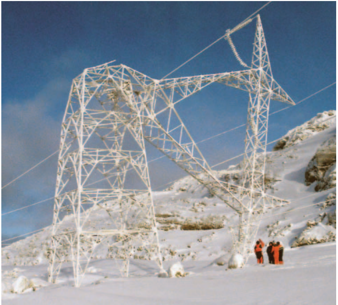
Havarert høyspentmast i norsk høyfjell. Foto: NVE
