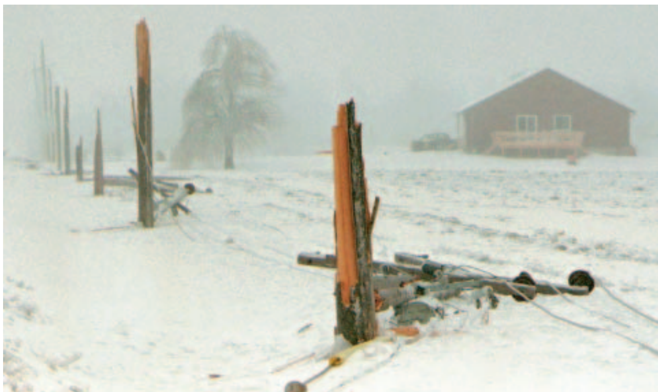
Strømstolper ødelagt av isstorm i Quebec i 1998. Foto: Tom Hanson/Scanpix
