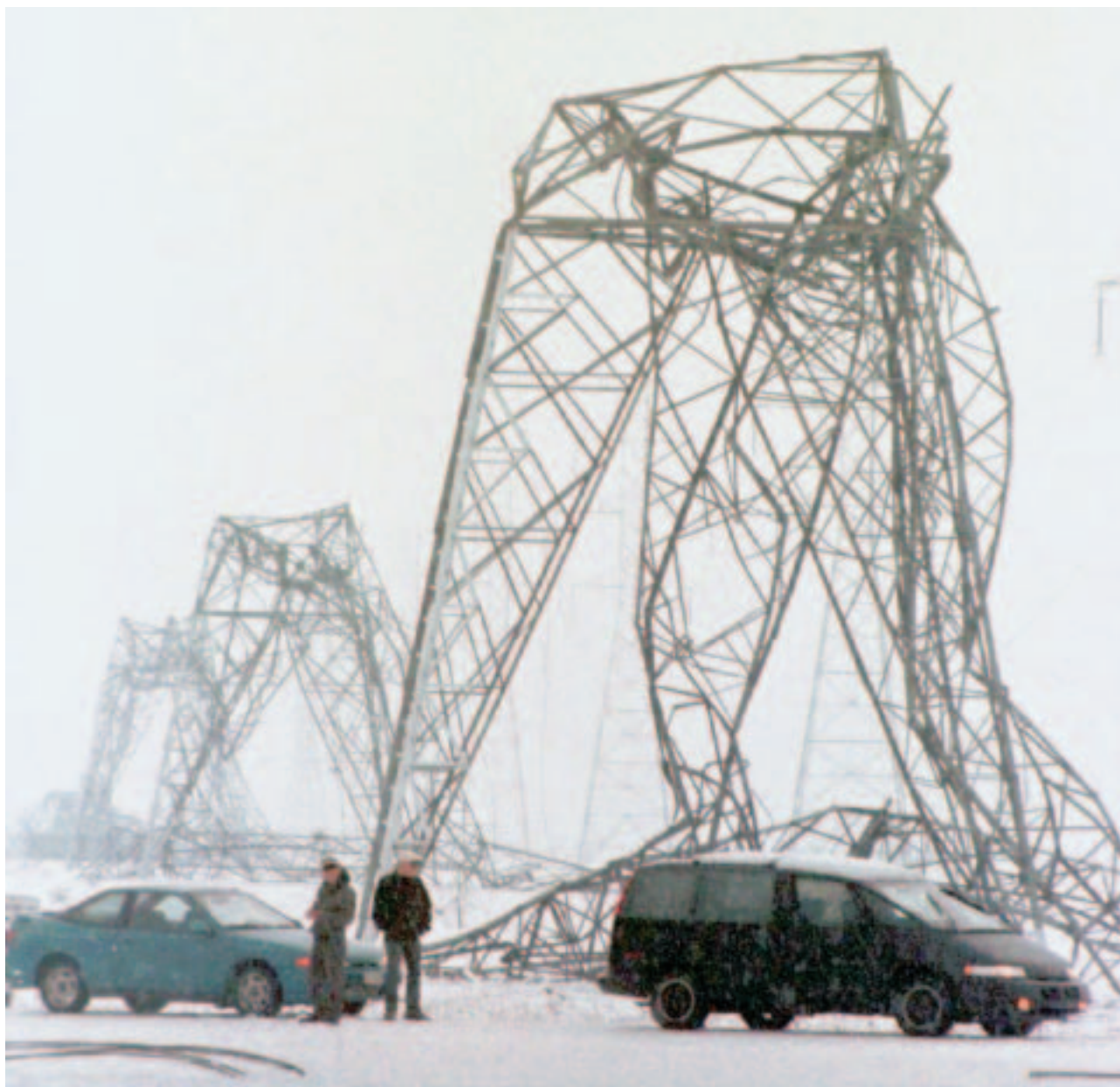
Havarerte høyspentmaster etter isstorm i Quebec i 1998. Foto: Jacques Boissinot/Scanpix
